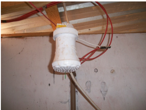
Figura 17 - Instalações sanitárias (chuveiro) sem instalações elétricas adequadamente protegidas - Obra D. Fonte: O autor (2018)
