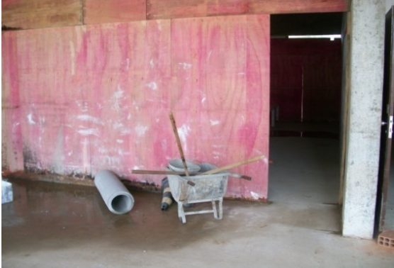
Figura 160 - Alojamento deve ter as paredes pintadas com tinta especial retardante à ação do fogo - Obra E. Fonte: O autor (2018)
