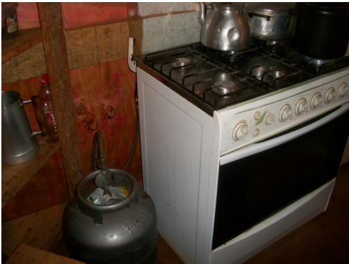
Figura 81 - Refeitório sem local exclusivo para o aquecimento de refeições, dotado de equipamento adequado e seguro para aquecimento (Botijão de gás ligado internamente) - Obra D. Fonte: O autor (2018)
