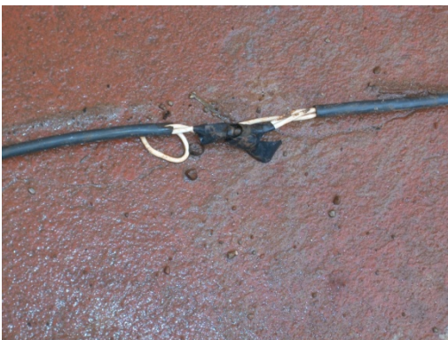
Figura 15 - Instalações elétricas desprotegidas - Obra C Fonte: O autor (2018)
