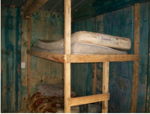
Figura 90 - Alojamento não tem pé-direito de 2,50m (dois metros e cinquenta centímetros) para cama simples e de 3,00m (três metros) para camas duplas - Obra F. Fonte: O autor (2018)
