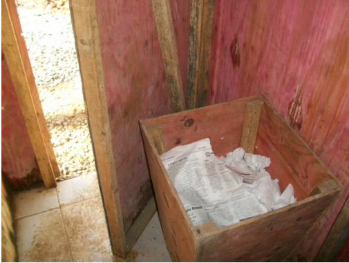
Figura 39 - Gabinete sanitário não é provido de porta com trinco interno e com borda inferior de, no máximo, 0,15m (quinze centímetros) - Obra E. Fonte: O autor (2018)
