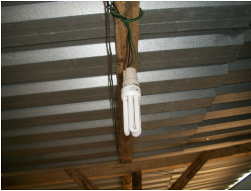
Figura 21 - Instalações sanitárias com instalações elétricas desprotegidas - Obra F. Fonte: O autor (2018)
