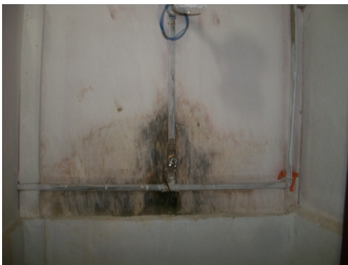
Figura 44 - Chuveiro sem aterramento - Obra B. Fonte: O autor (2018)
