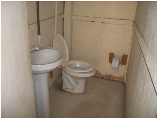
Figura 40 - Gabinete sanitário sem recipiente de papel sem tampa - Obra E. Fonte: O autor (2018)
