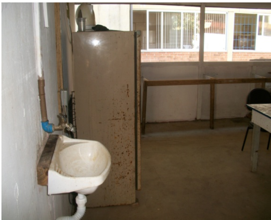
Figura 155 - No refeitório não existe água potável e deveria existir uma advertência quanto a sua não potabilidade - Obra B. Fonte: O autor (2018)
