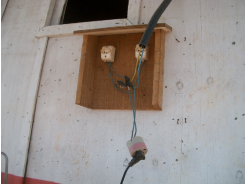
Figura 119 - Instalações sanitárias com rede de iluminação não protegida por eletrodutos - Obra D. Fonte: O autor (2018)
