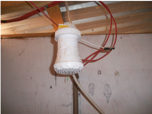
Figura 46 - Chuveiro elétrico sem aterramento - Obra D. Fonte: O autor (2016)
