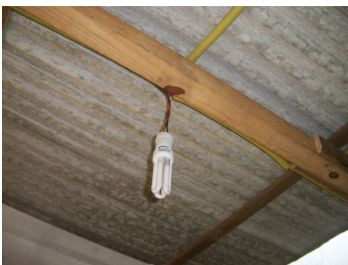
Figura 131- Instalações elétricas sem proteção por eletrodutos - Obra B. Fonte: O autor (2018)
