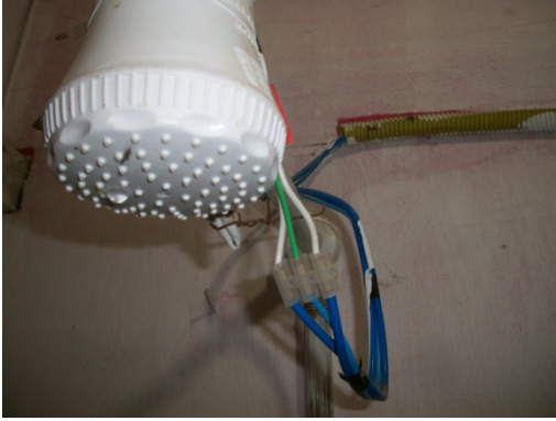
Figura 165 - Os chuveiros elétricos devem ser aterrados de maneira correta - Obra C. Fonte: O autor (2018)
