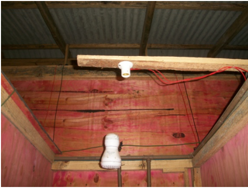
Figura 23 - Instalações sanitárias sem instalações elétricas adequadamente protegidas - Obra G. Fonte: O autor (2018)
