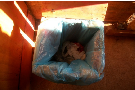
Figura 161 - O lixo do alojamento deverá ser retirado diariamente e depositado em local adequado - Obra E. Fonte: O autor (2018)
