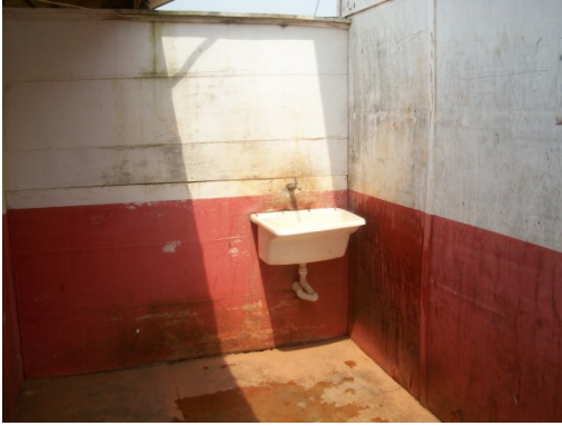
Figura 29 - Instalações sanitárias sem recipiente para coleta de papéis usados - Obra D. Fonte: O autor (2018)
