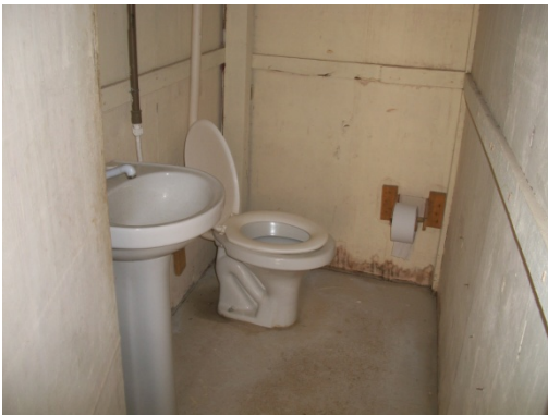
Figura 71 - Refeitório apresenta comunicação direta com as instalações sanitárias - Obra E. Fonte: O autor (2018)
