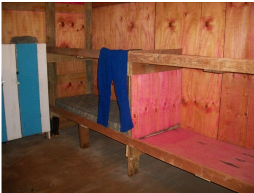
Figura 87 - Alojamento sem área de ventilação e não possui pé-direito com altura compatível para cama simples e dupla - Obra E. Fonte: O autor (2018)
