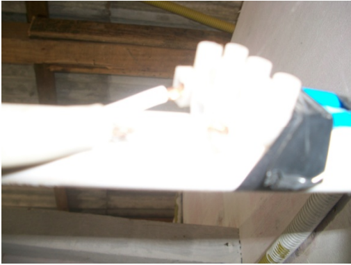
Figura 114 27- Instalação elétrica com fiação não protegida por eletrodutos - Obra B. Fonte: O autor (2018)
