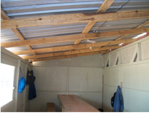
Figura 218 - Local para refeição com pé-direito inferior a 2,80m - Obra D. Fonte: O autor (2018)
