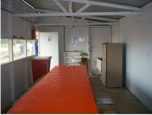
Figura 72 - Ao fundo o local para refeições tem comunicação direta com as instalações sanitárias - Obra F.
