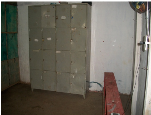
Figura 59 - Vestiário não tem bancos em número suficiente para atender aos usuários, com largura mínima de 0,30m (trinta centímetros) - Obra F.
