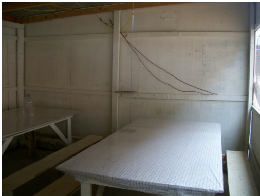
Figura 146 - Refeitório com rede de iluminação desprotegida por eletrodutos - Obra C. Fonte: O autor (2018)
