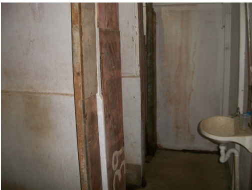
Figura 13 - Instalações sanitárias sem portas de acesso que impeçam o devassamento e construídas de modo a manter o resguardo conveniente – Obra B Fonte: O autor (2018)
