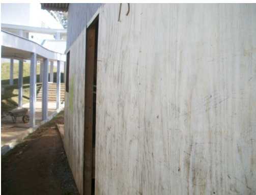
Figura 168 - As pinturas das paredes, portas e janelas, móveis e utensílios do alojamento, quando de madeira, devem ser de tinta especial retardante à ação do fogo - Obra G. Fonte: O autor (2018)
