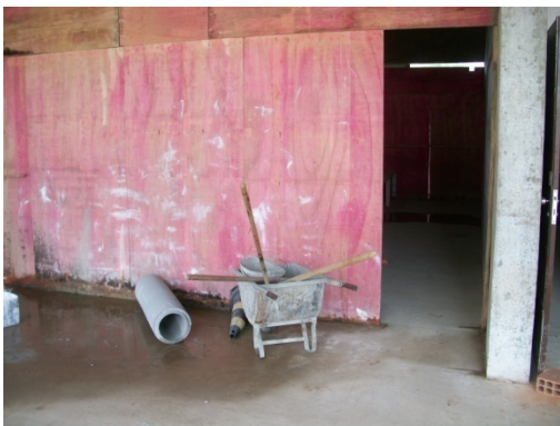
Figura 164 - Alojamento deve ter as paredes pintadas com tinta especial retardante à ação do fogo - Obra F.
