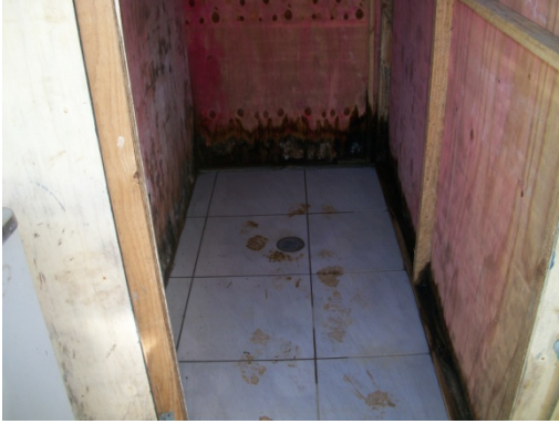
Figura 112 - Instalações sanitárias sem conservação e higiene - Obra G. Fonte: O autor (2018)
