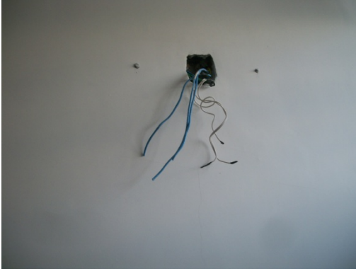
Figura 136 - Vestiário com rede de iluminação sem proteção por eletrodutos - Obra F. Fonte: O autor (2018)
