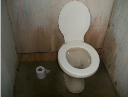
Figura 20 - Instalações sanitárias sem conservação e higiene - Obra F. Fonte: O autor (2018)
