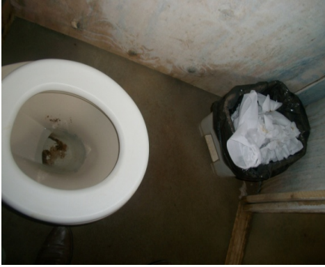
Figura 41 - Vaso sanitário sem recipiente para coleta de papéis usados - Obra F. Fonte: O autor (2016)
