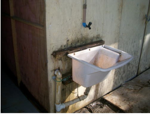
Figura 33 - Lavatório não fica a uma altura de 0,90m (noventa centímetros) - Obra G. Fonte: O autor (2016)
