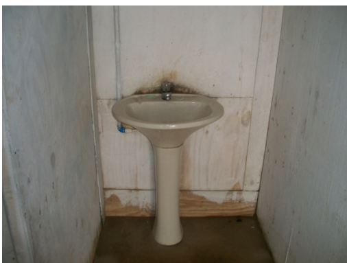
Figura 105 - Lavatório sem material para a limpeza, enxugo ou secagem das mãos, proibindo-se o uso de toalhas coletivas - Obra F.
