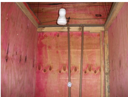
Figura 122 - Instalações sanitárias com chuveiros em número insuficientes - Obra G. Fonte: O autor (2018)
