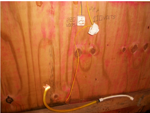
Figura 19 - Instalações sanitárias com instalações elétricas desprotegidas - Obra E. Fonte: O autor (2018)
