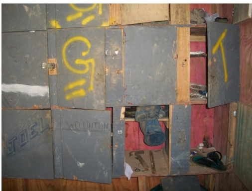
Figura 143 - Vestiário não possuem armários com compartimentos duplos com dimensões mínimas conforme estabelecido pela norma - Obra G.
