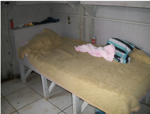
Figura 95 - Alojamento não tem área mínima de 3,00m 2 (três metros) quadrados por módulo cama/armário, incluindo a área de circulação - Obra G.
