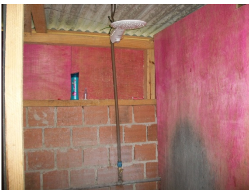
Figura 43 - Chuveiro sem suporte para sabonete e cabide para toalha - Obra B. Fonte: O autor (2018)
