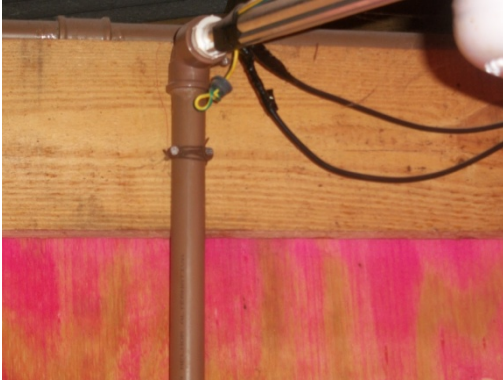
Figura 47 - Chuveiros elétricos devem ser aterrados adequadamente - Obra E. Fonte: O autor (2016)
