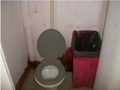
Figura 12- Instalações sanitárias deve ser mantida em perfeita conservação e higiene – Obra B Fonte: O autor (2018)
