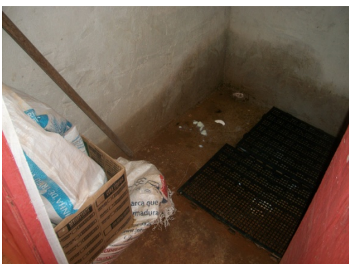
Figura 112 - Instalações sanitárias (banheiro) com chuveiro não estão sendo mantidos em estado de conservação, asseio e higiene - Obra E.
