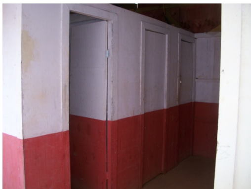
Figura 123 - Gabinetes sanitários com paredes divisórias com altura inferior a 2,10m e seu bordo inferior não poderá situar-se a mais de 0,15 m acima do pavimento - Obra D. Fonte: O autor (2018)
