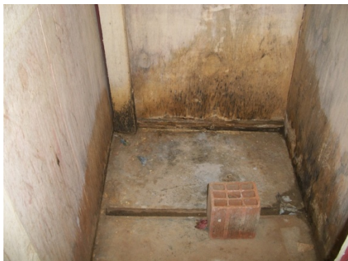
Figura 102 - Instalações sanitárias sem condições de uso - Obra C. Fonte: O autor (2018)
