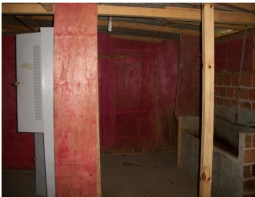
Figura 100 - Instalações sanitárias sem higiene - Obra A. Fonte: O autor (2018)
