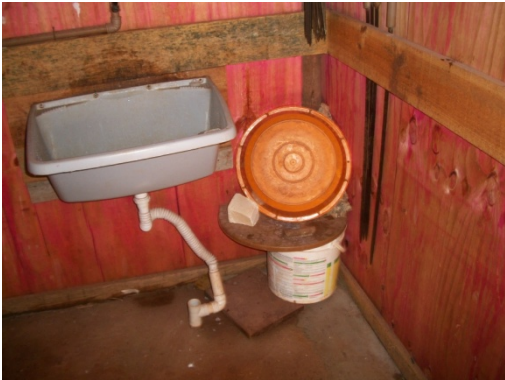
Figura 30 14- Lavatório deve ser individual ou coletivo, tipo calha e não dispõem de recipiente para coleta de papéis usados - Obra E. Fonte: O autor (2018)
