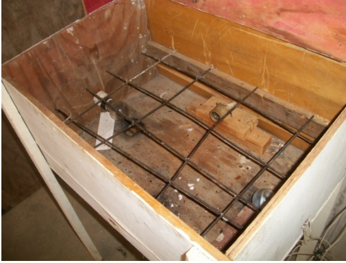
Figura 80 - Equipamento improvisado para aquecimento da alimentação (marmitas) - Obra C. Fonte: O autor (2018)
