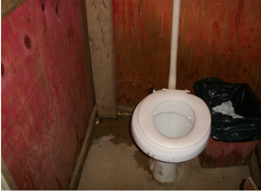
Figura 157 - Vaso sanitário (gabinete sanitário) sem recipiente com tampa - Obra C. Fonte: O autor (2018)
