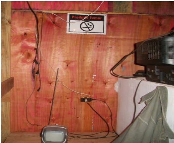
Figura151 - Refeitório cuja fiação deverá ser protegida por eletrodutos - Obra E. Fonte: O autor (2018)
