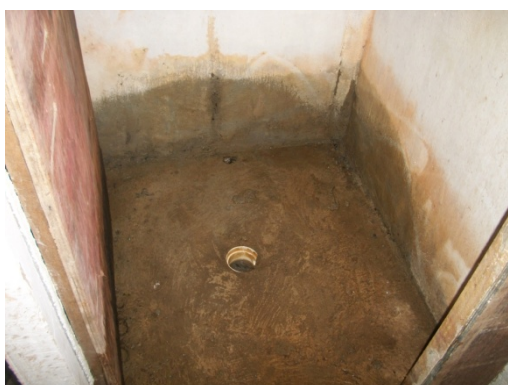
Figura 108 - Banheiros dotados de chuveiros devem ser mantidos em estado de conservação, asseio e higiene - Obra B.
