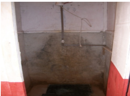
Figura 111 - Chuveiros devem ser mantidos em estado de conservação, asseio higiene - Obra D. Fonte: O autor (2018)
