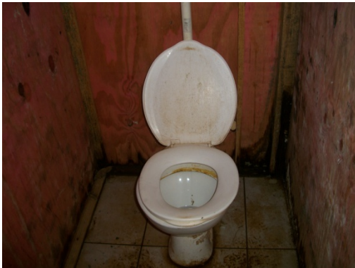
Figura 106 - Instalações sanitárias não estão sendo submetidos a processo permanente de higienização - Obra G.
