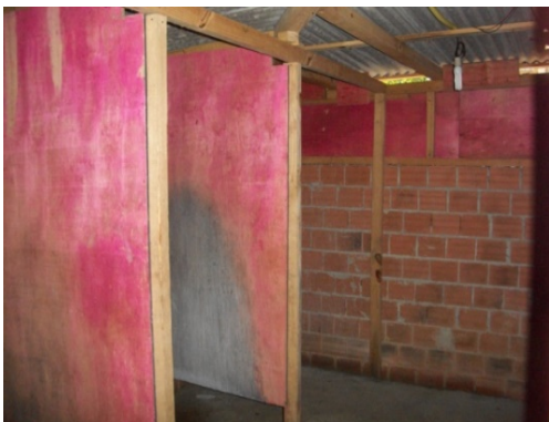
Figura 36 - Gabinete dos vasos sanitários sem porta - Obra C.
