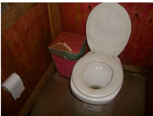
Figura 103 - Instalações Sanitárias sem higienização permanente - Obra E. Fonte: O autor (2018)
