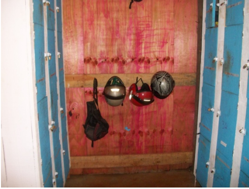
Figura 3034 - Vestiário com dimensões inferiores das indicadas pela norma - Obra E. Fonte: O autor (2018)
