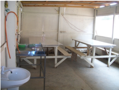
Figura 148 - Refeitório sem fornecimento de água potável - Obra C. Fonte: O autor (2018)
