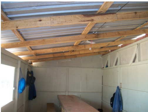
Figura 149 - Refeitório deve ter rede protegida por eletrodutos – Obra D. Fonte: O autor (2018)
