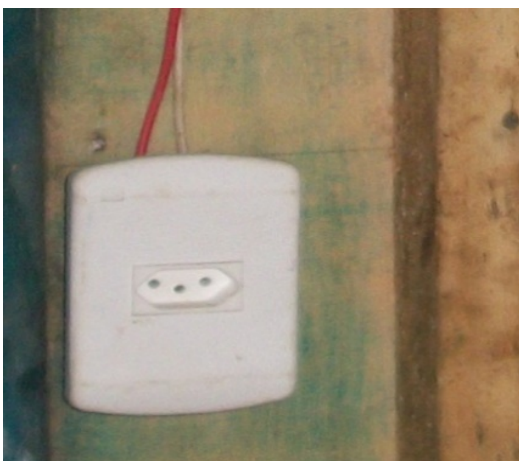
Figura 163 - Alojamento com rede de iluminação desprotegida por eletrodutos - Obra F. Fonte: O autor (2018)
