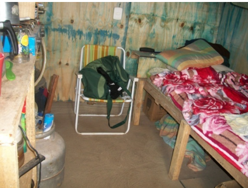
Figura 89 - Alojamento sem área de ventilação de no mínimo 1/10 (um décimo) da área do piso - Obra F.
