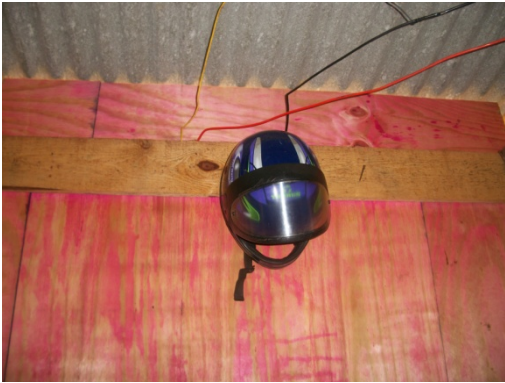
Figura 135 - Vestiário cuja fiação deverá ser protegida por eletrodutos - Obra E. Fonte: O autor (2018)
