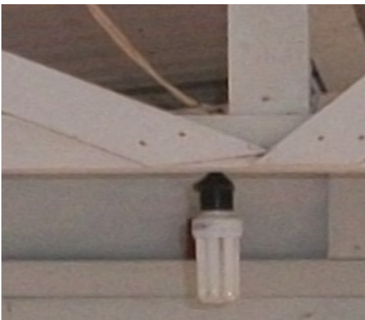
Figura 153 - Refeitório com rede de iluminação sem proteção por eletrodutos - Obra F. Fonte: O autor (2018)
