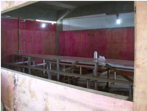
Figura 3145 - Refeitório sem lâmpadas adequadas - Obra A. Fonte: O autor (2018)
