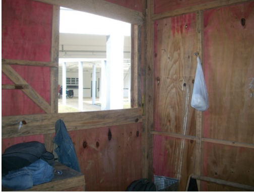
Figura 60 - Vestiário sem área de ventilação correspondente a 1/10 (um décimo) de área do piso - Obra G. Fonte: O autor (2018)
