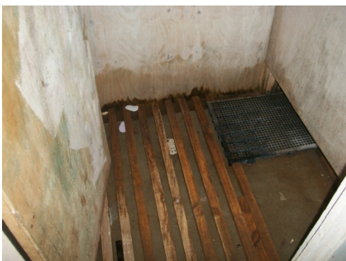
Figura 113 - Banheiros com chuveiros devem ser mantidos em estado de conservação, asseio e higiene - Obra F.
