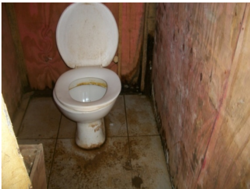
Figura 107 - Instalações sanitárias sem higiene - Obra A. Fonte: O autor (2018)
