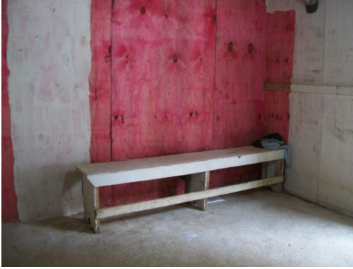
Figura 54 - Vestiário não tem bancos em número suficiente para atender aos usuários e com largura mínima de 0,30 m - Obra C. Fonte: O autor (2018)
