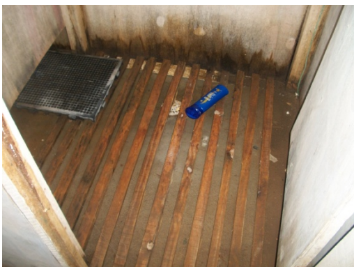
Figura 104 - Instalações sanitárias sem higienização, desprovidos de quaisquer odores durante toda a jornada de trabalho - Obra F.
