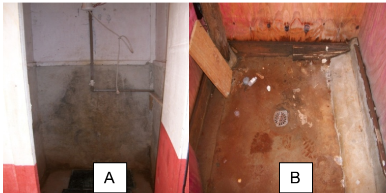
Figura 42 - Chuveiro. A) Área mínima 0,80 m 2 com altura de 2,10 m; B) Pisos com caimento - Obra A.
