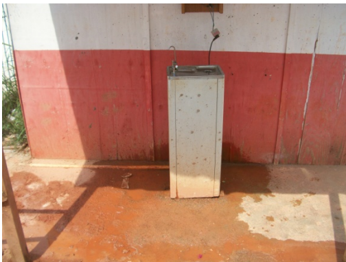
Figura 150 - Refeitório sem água potável e sem condições higiênicas - Obra D. Fonte: O autor (2018)
