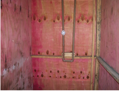
Figura 49 - Chuveiro sem suporte para sabonete e cabide para toalha - Obra G. Fonte: O autor (2018)
