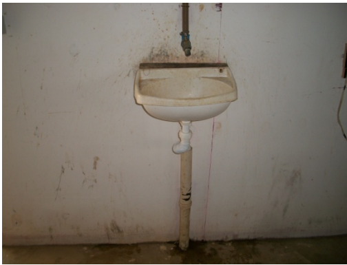
Figura 25 - Lavatório - Obra A. Fonte: O autor (2018)
