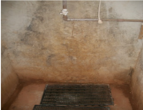
Figura 16 - Instalações sanitárias não estão em perfeito estado de conservação e higiene - Obra D. Fonte: O autor (2018)
