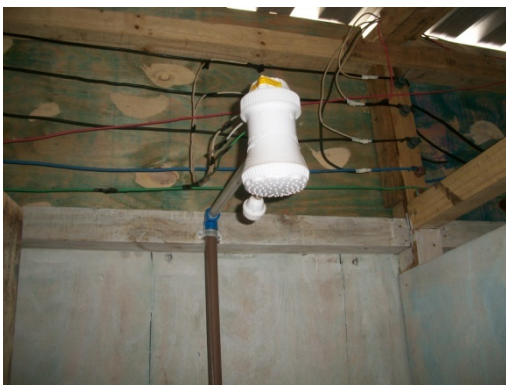
Figura 121 - Instalações sanitárias com rede de elétrica sem proteção por eletrodutos - Obra F. Fonte: O autor (2018)
