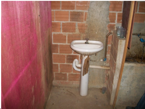
Figura 24 - Lavatório - Obra A. Fonte: O autor (2016)
