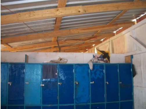
Figura 55 - Vestiário com pé-direito inferior a 2,50m - Obra D. Fonte: O autor (2018)
