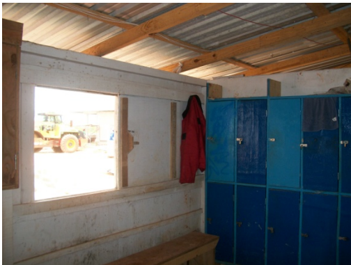
Figura 133 - Vestiário será provido de uma rede de iluminação, cuja fiação deverá ser protegida por eletrodutos - Obra D. Fonte: O autor (2016)
