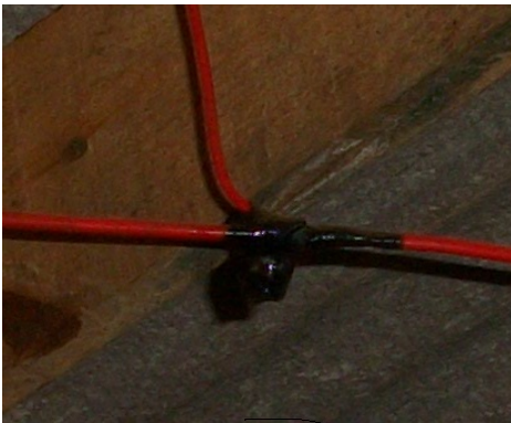
Figura 137 - Vestiário com rede de iluminação sem proteção por eletrodutos - Obra G. Fonte: O autor (2018)
