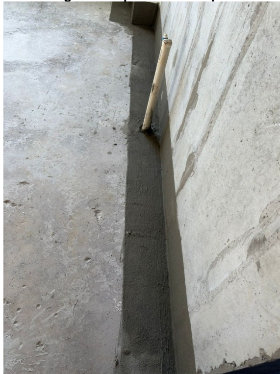
Fotografia 8 - Argamassa polimérica na parede da cozinha
