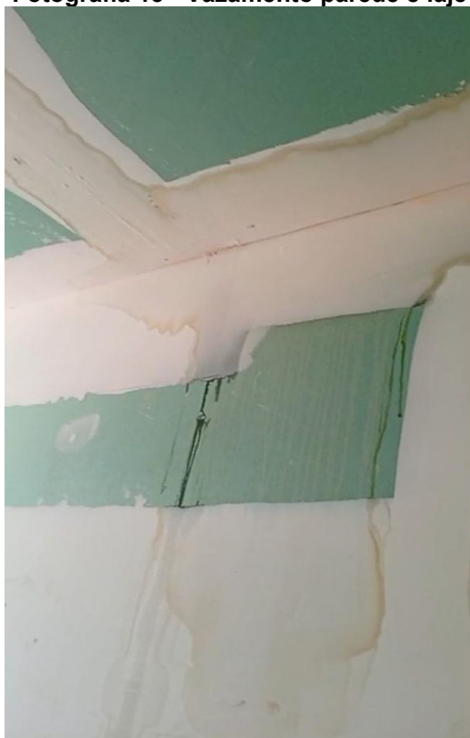
Fotografia 13 - Vazamento parede e laje
