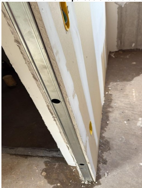
Fotografia 12 - Vazamento parede externa do banheiro
