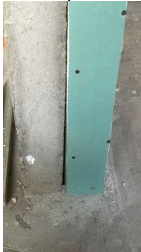
Fotografia 32 – Desencontro presente na circulação
