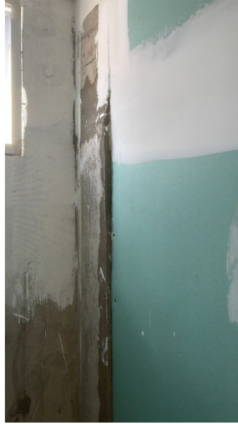
Fotografia 28 – Desencontro entre drywall e concreto no banheiro
