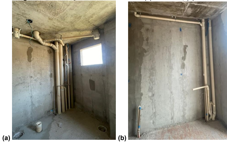
Fotografia 1 - Instalações hidrossanitárias: (a) Banheiro; (b) Cozinha
