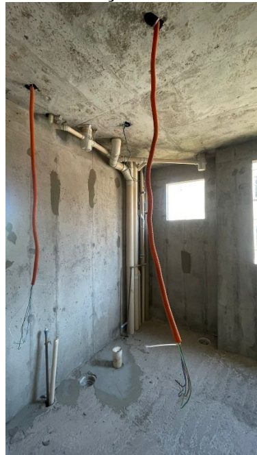
Fotografia 2- Instalações elétricas do banheiro
