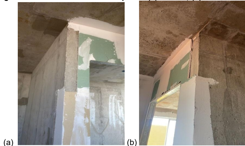
Fotografia 33 – Corte incorreto na placa: (a) Vista 1; (b) Vista 2
