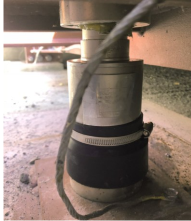
Figura 4 – Exemplo de sensor de pressão acoplado à uma célula de carga monitorando uma ponte.
