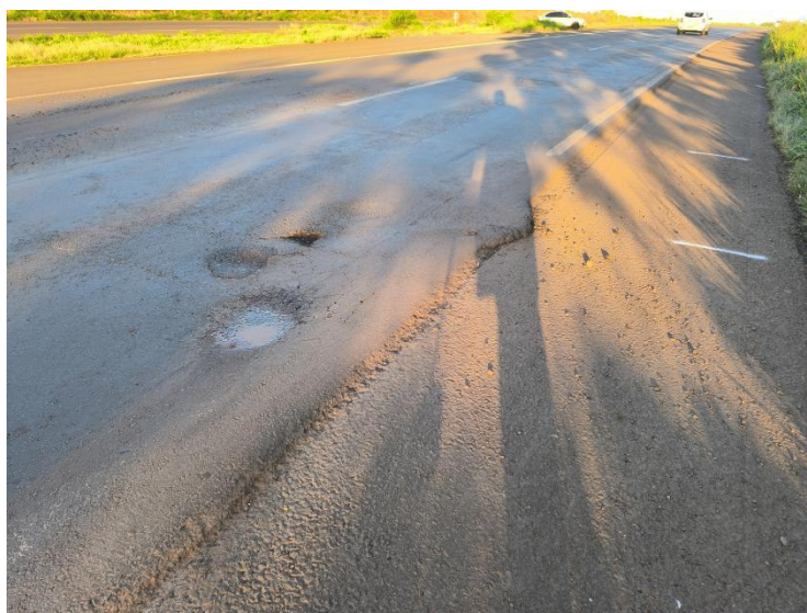
Figura 33 – Formação de panelas em zonas com drenagem ineficiente.
