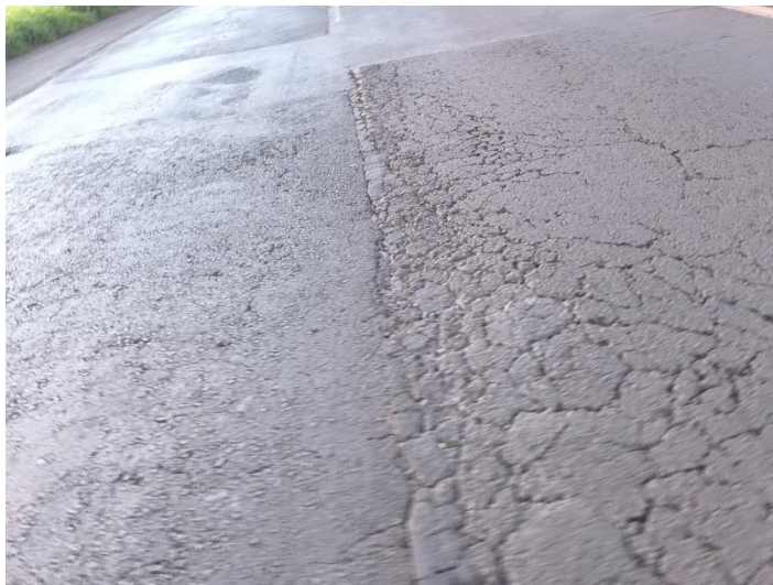
Figura 32 – Trincas interligadas com erosão nos bordos.
