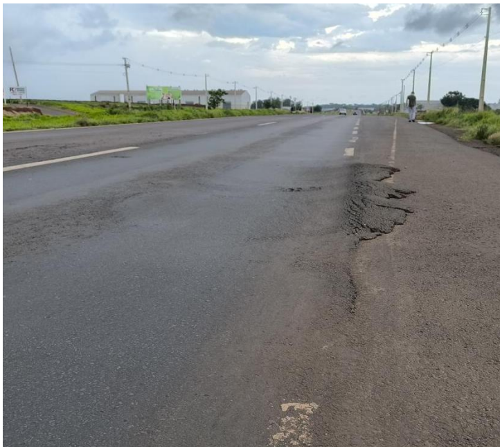
Figura 34 – Erosão lateral em pontos de surgimento de panelas.
