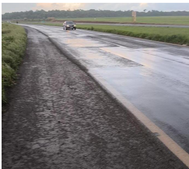
Figura 31 – Afundamento plástico com acúmulo de água na trilha de roda.
