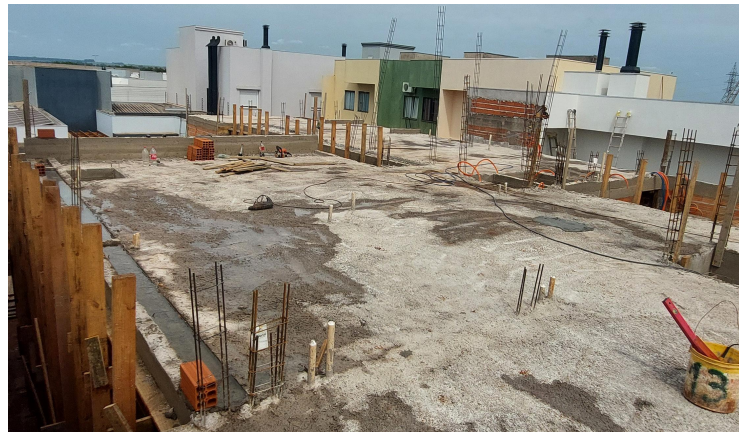
c) Laje Forro - Obra 2
