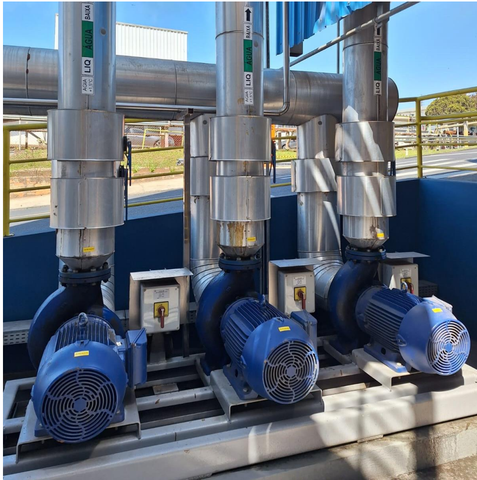
Figura 7 – Bombas de pressurização do Termoacumulador
