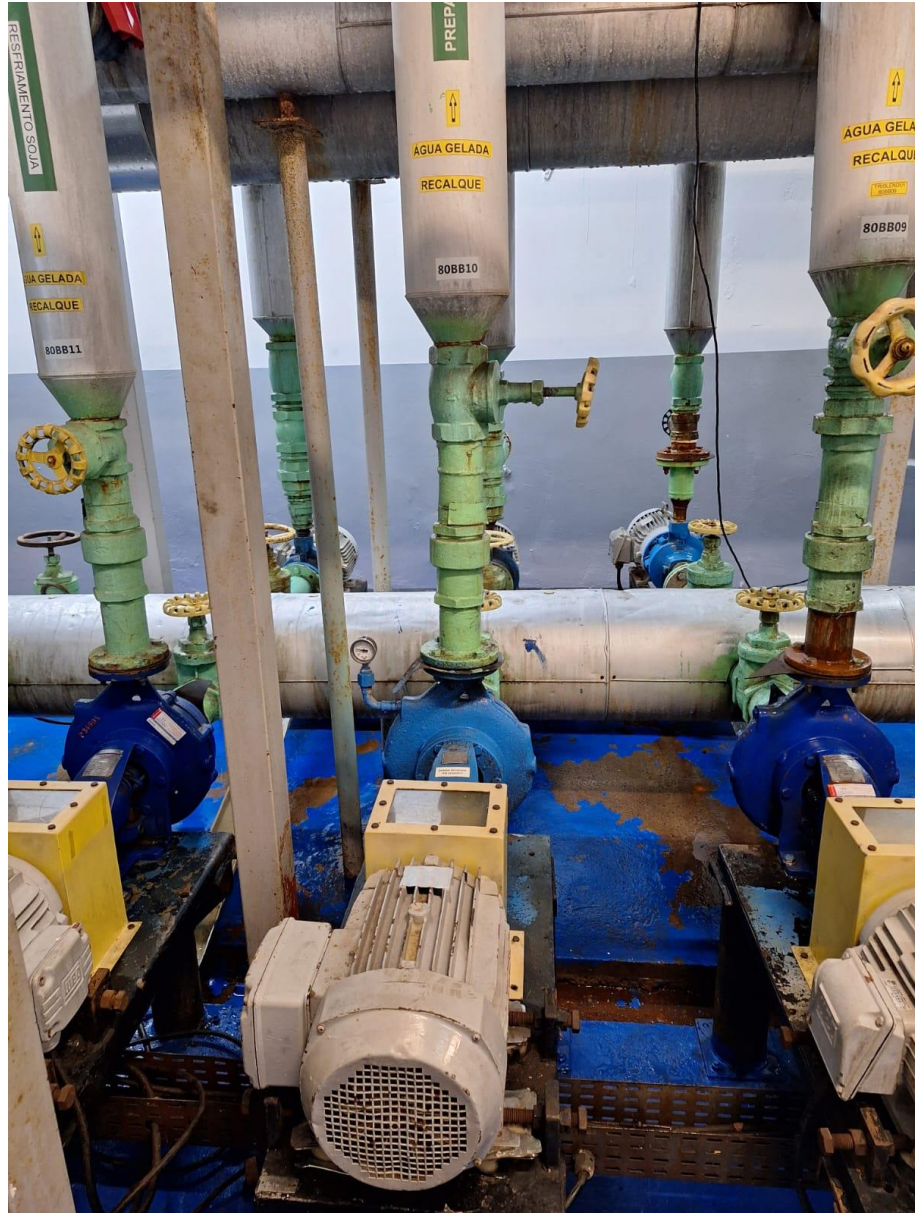
Figura 5 – Conjunto tubulação e bomba dedicada WEG Fonte: Autoria Própria (2025)
