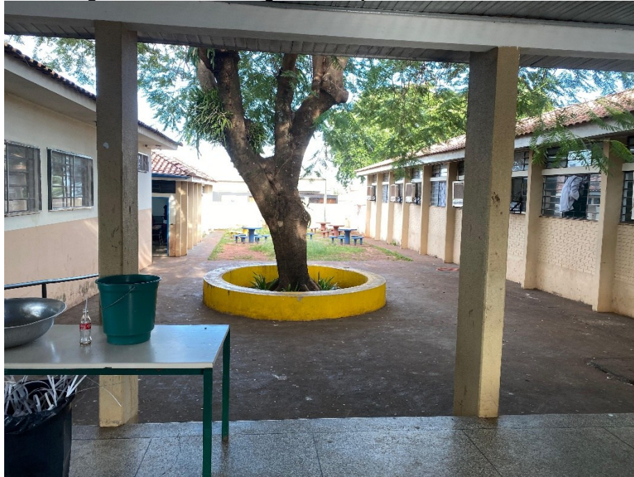
Fotografia 17 – Falta de guarda-corpo nos limites do refeitório
