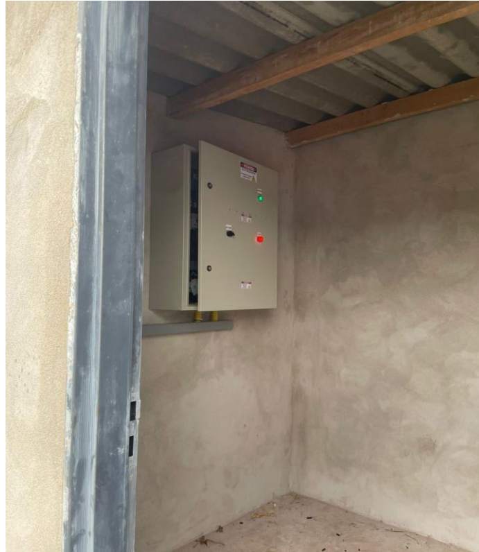
Figura 17 – Vista lateral do painel starter do poço Parque Industrial
