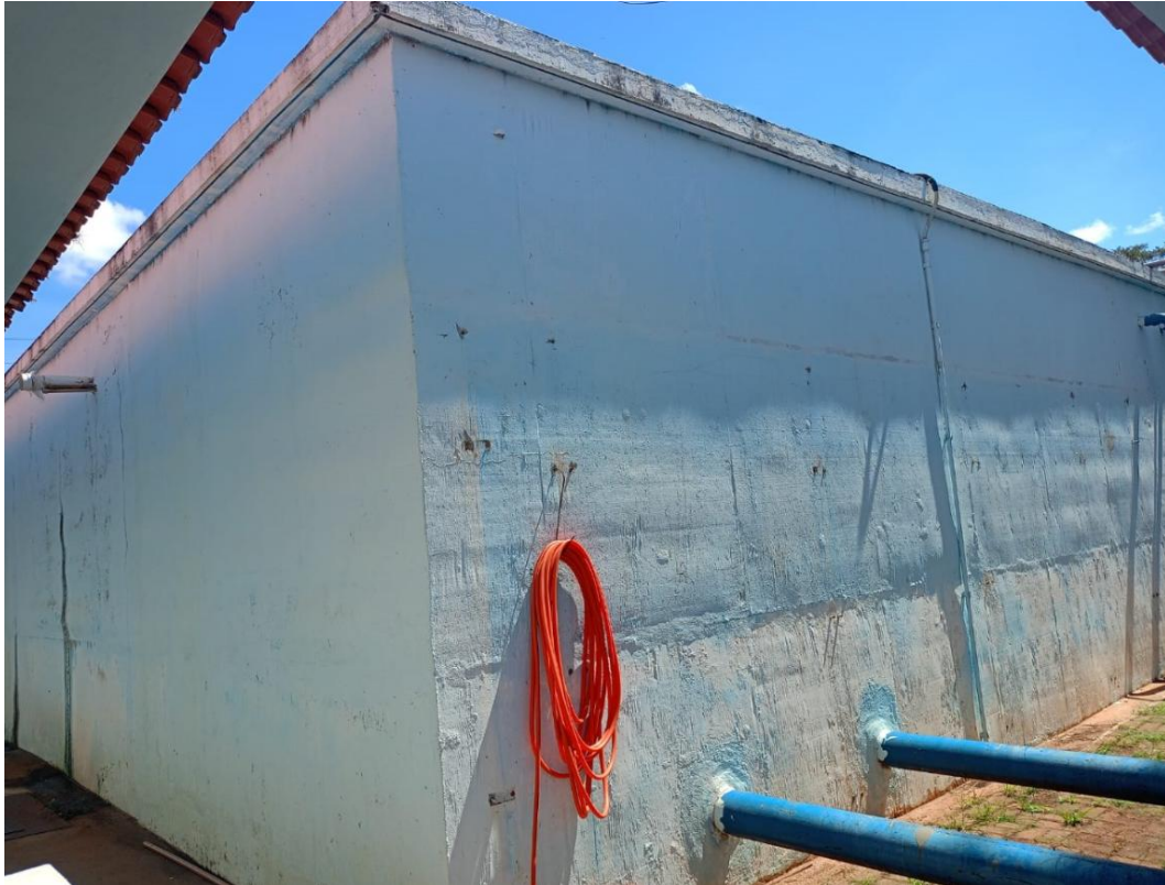
Figura 12 – Vista frontal do reservatório de água tratada do SAAE de Pitangueiras
