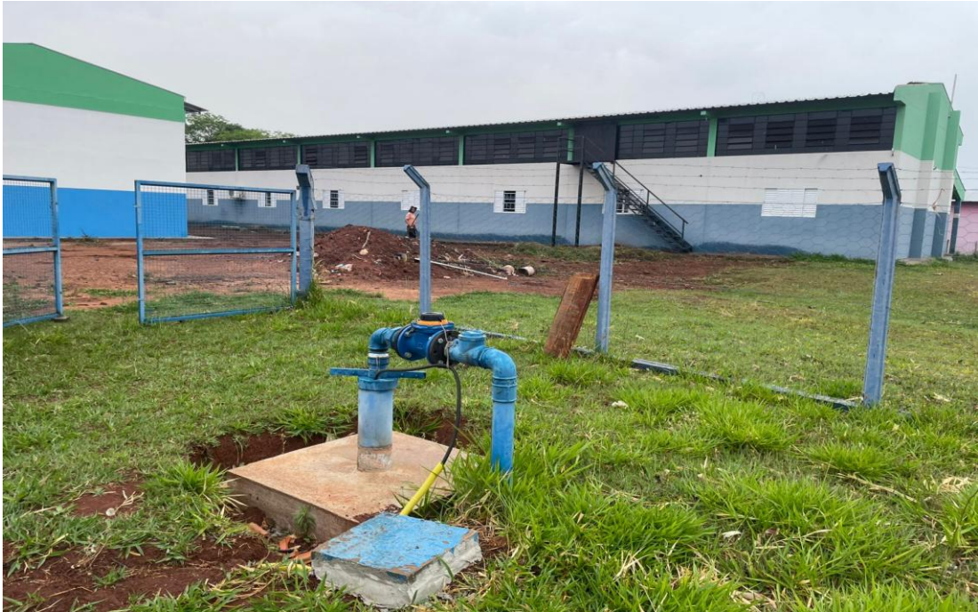
Figura 19 – Vista frontal do ponto de captação do poço Parque Industrial
