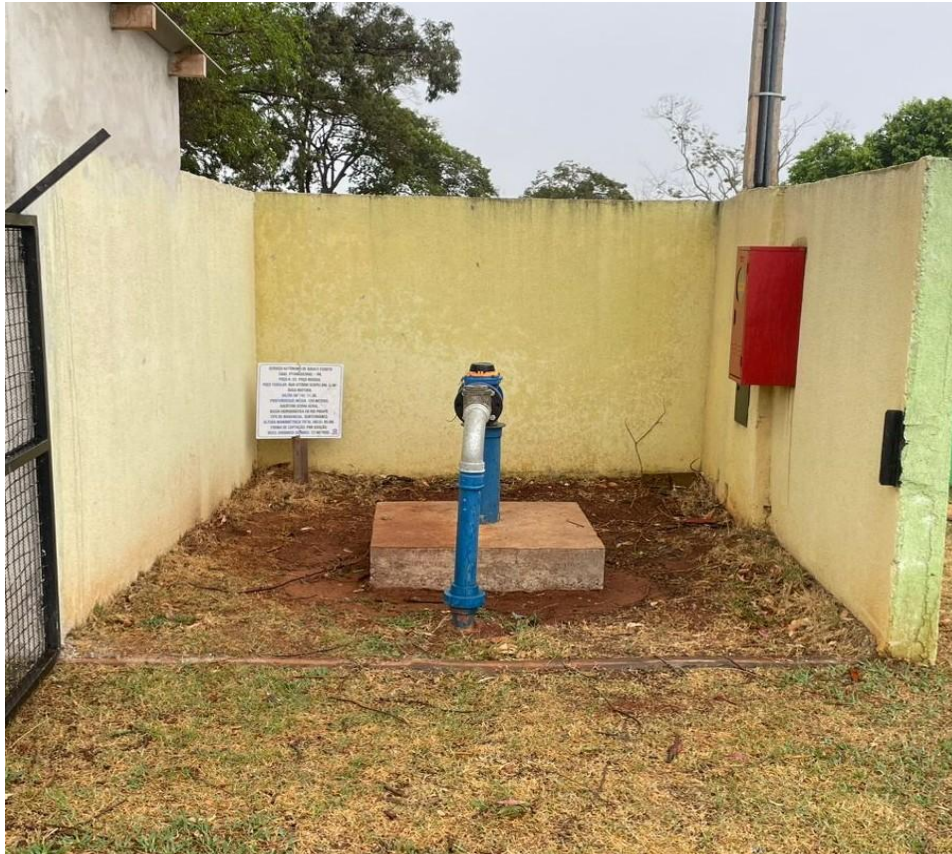
Figura 14 – Vista frontal do local de captação do poço Bosque
