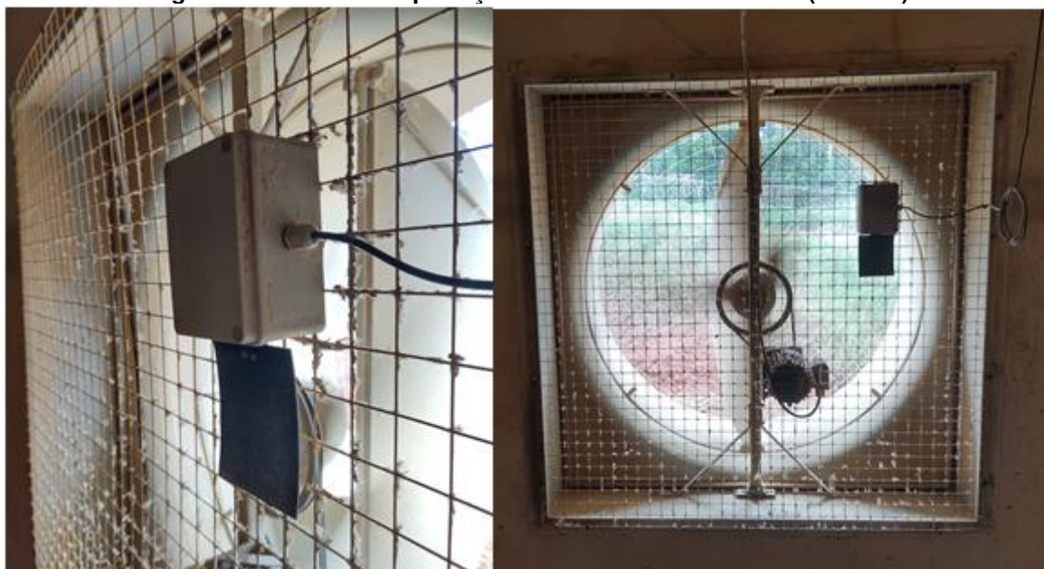
Figura 10 - Sistema de proteção contra falhas mecânicas (Palheta)
