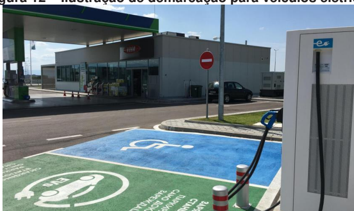
Figura 12 – Ilustração de demarcação para veículos elétricos
