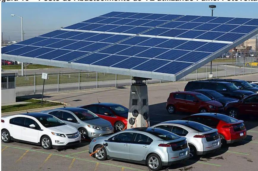
Figura 10 – Posto de Abastecimento de VE utilizando Painel Fotovoltaico
