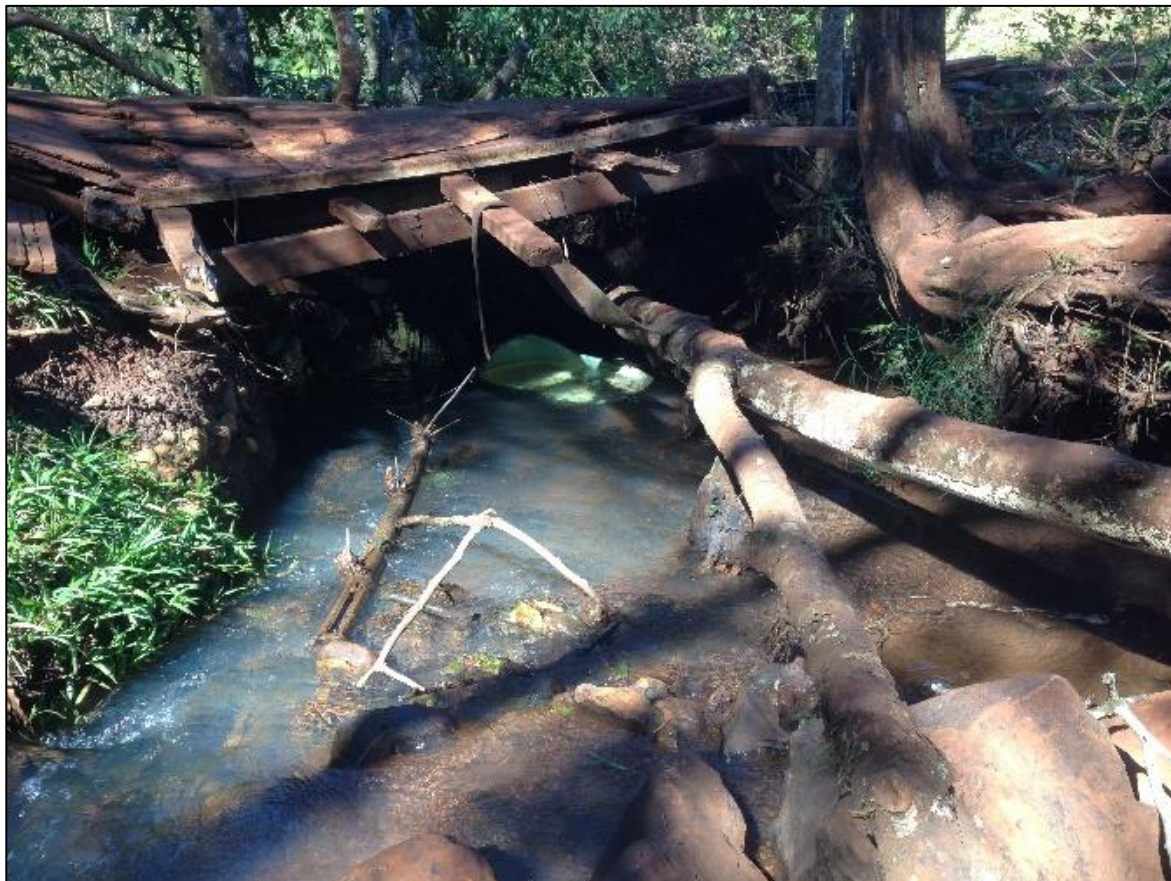
Figura 46: Sacola plástica e carcaça de animal morto embaixo da ponte irregular sobre o Ribeirão Cambé (P3-Cambé).
