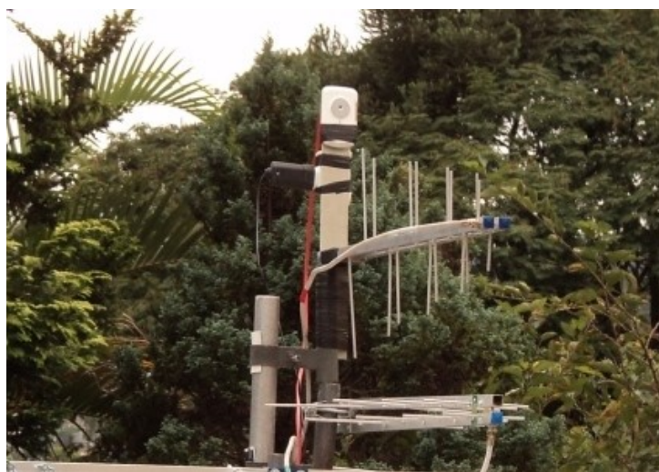
Figura 19 – Foto da antena receptora instalada na vertical e horizontal
