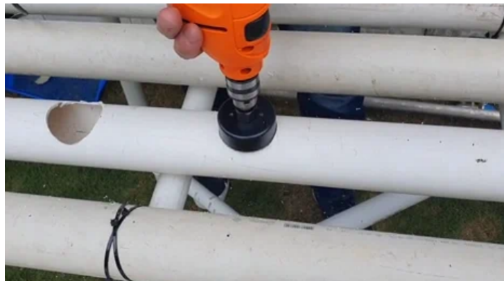
Figura 23 – Orifícios das calhas do sistema.
