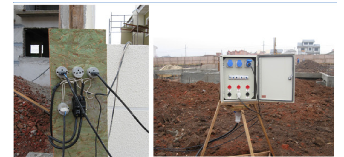
Figura 9 – Fotos das instalações elétricas antes e depois da implantação do SG-HSSMAT Fonte: Dados do autor, 2011.
