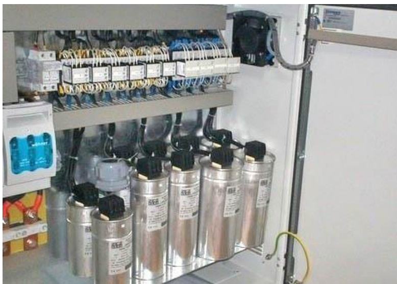
Figura 7 - Banco de capacitores utilizado na correção do FP.
