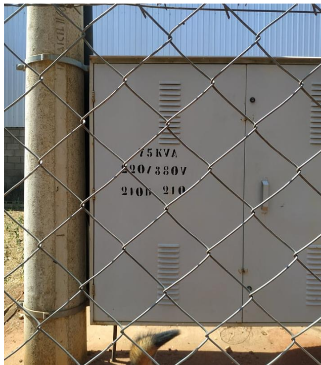
Figura 12 – Cabine de medição indireta.
