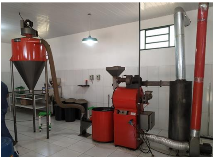
Figura 18 – Area interna de torrefação.
