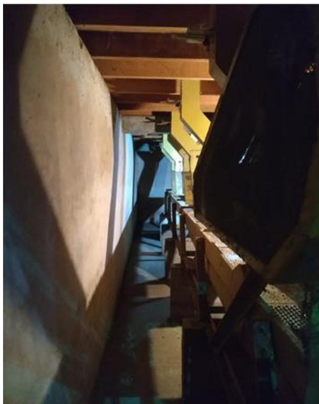
Figura 30 – Interior túnel 2 de lavagem, lado esquerdo.
