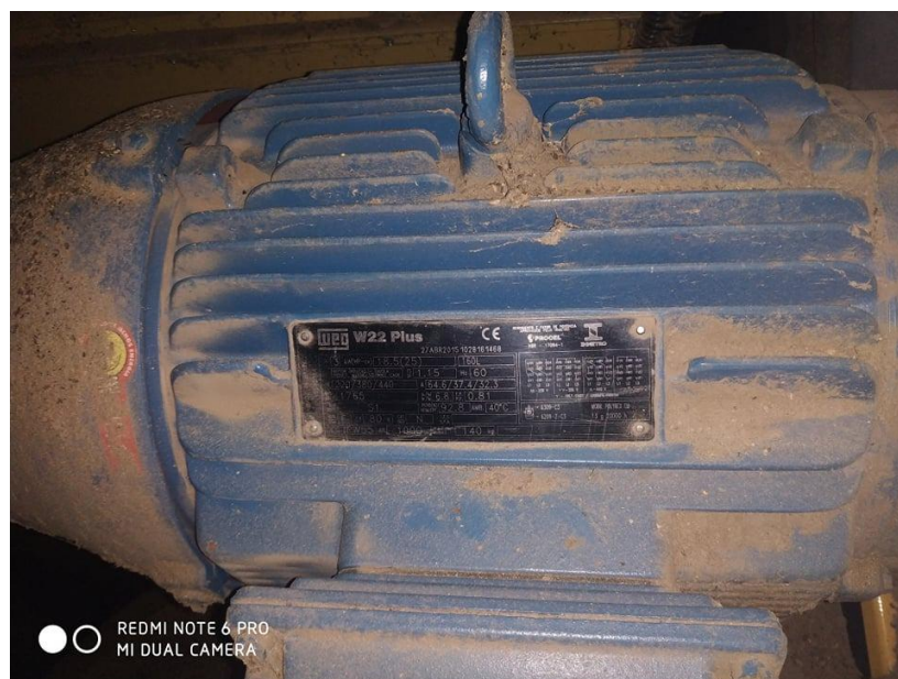
Figura 34 – Detalhe do motor elétrico de 25 cavalos.
