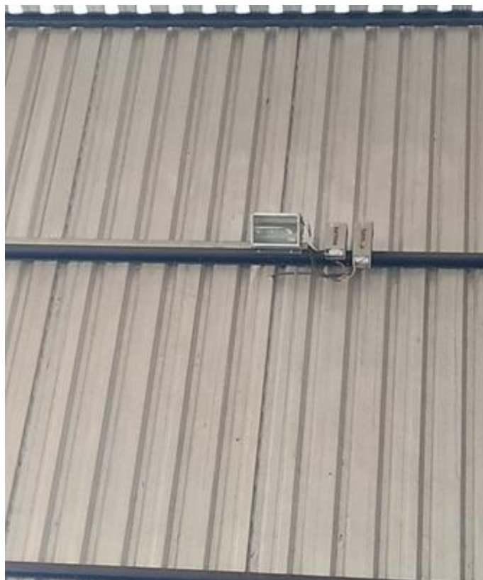
Figura 26 – Refletor vapor de mercúrio com dois reatores, área de beneficiamento.
