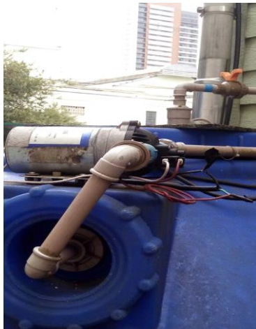
Figura 15 – Válvula de controle da vazão e bomba fotovoltaica
