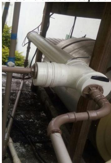
Figura 16 – Sistema de desinfecção ultravioleta
