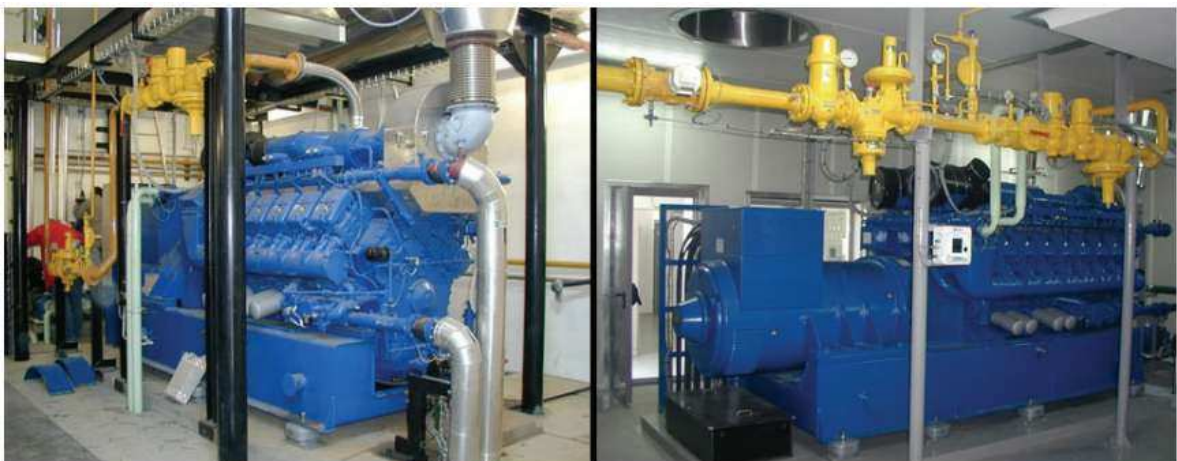
Figura 1 - Gerador a biogás.
