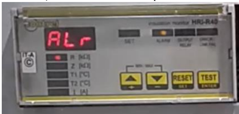
Fotografia 6 - Indicação do DSI com curto-circuito e queda da resistência de isolamento
