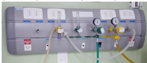
Figura 20 - Régua elétrica e de gases Air Liquide Conectal
