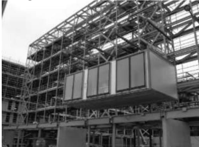
Figura 2 - Módulos suportados por estrutura
