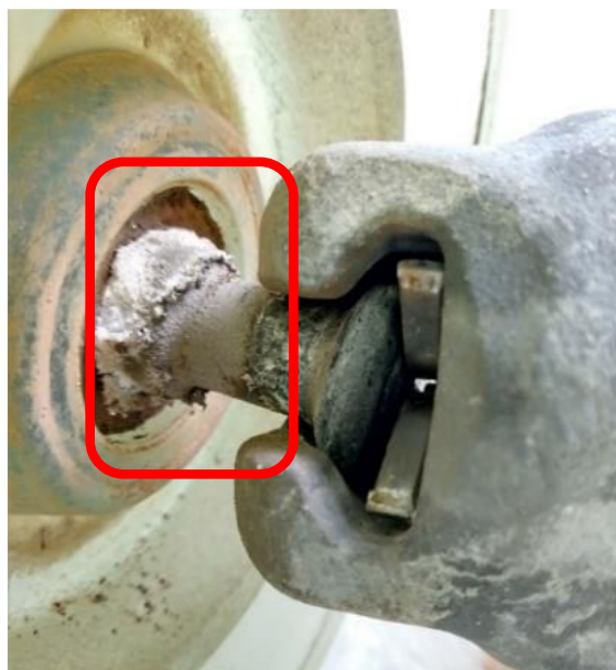
Figura 3: Exemplo de corrosão branca em pino de isolador de disco de vidro.
