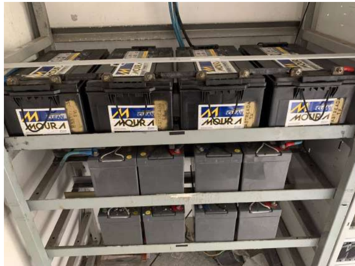
Figura 13 – Banco de Baterias
