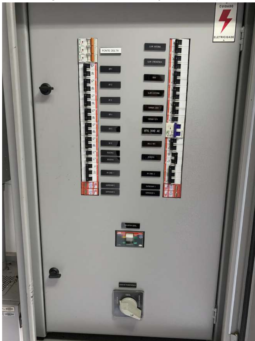
Figura 8 – Quadro de Distribuição Geral (QDG)
