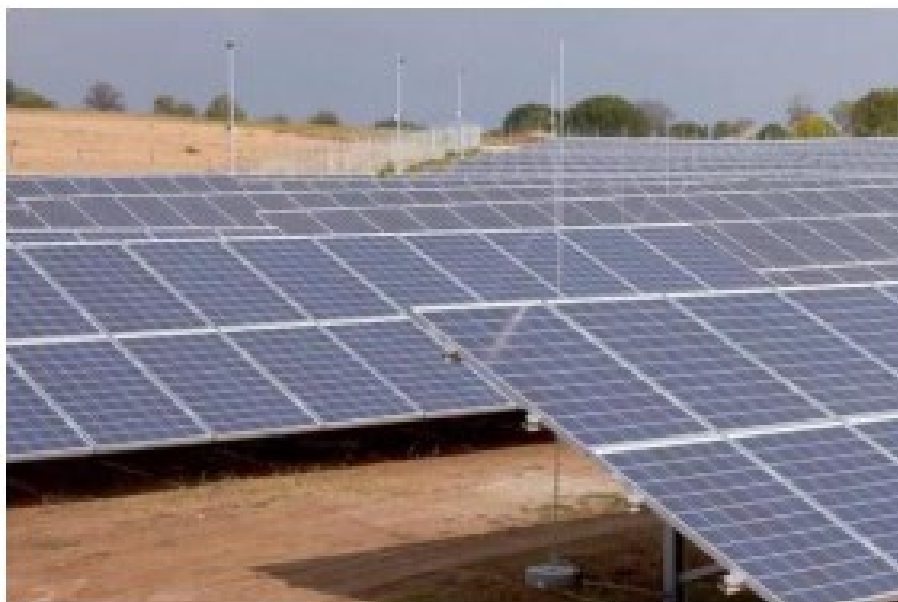
Figura 15 - Instalações reais de um SPDA em um sistema fotovoltaico
