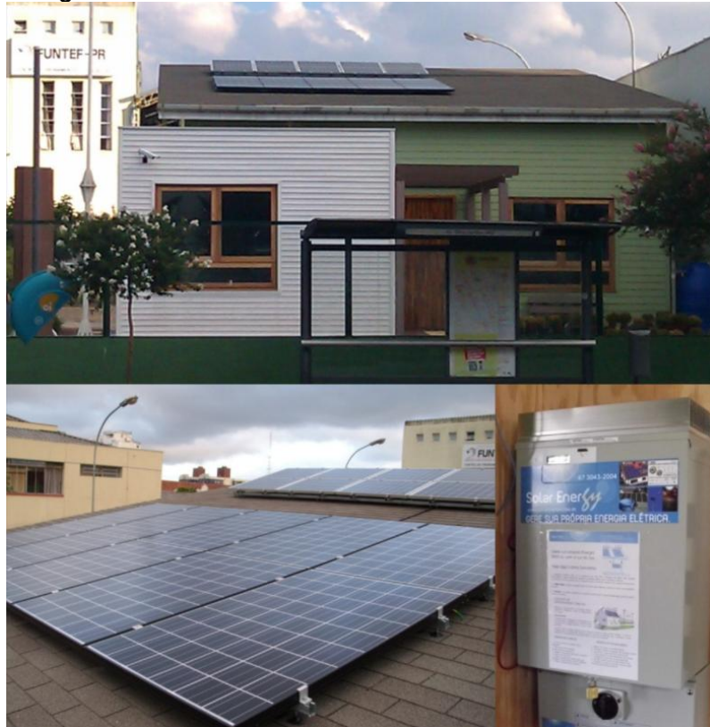
Figura 27 - SFCR instalado no Escritório Verde da UTFPR
