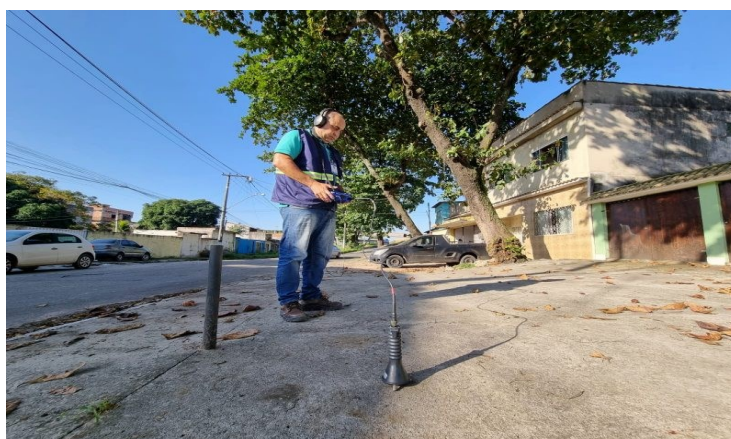
Fotografia 1 - Técnico realizando varredura em rede de água para a detecção do vazamento
