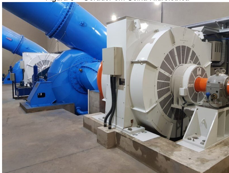
Figura 6 – Gerador em Usina Hidrelétrica
