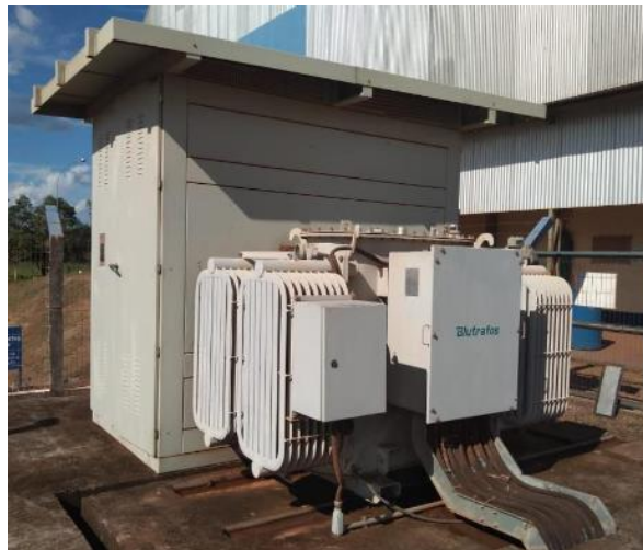
Figura 6 - Subestação – cabine primária
