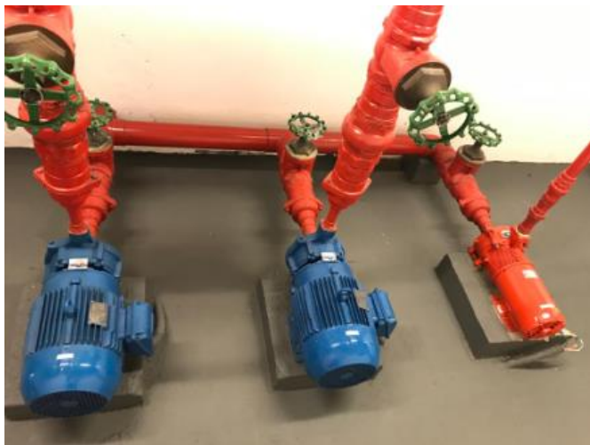
Figura 2 – Bombas Sistema de incêndio
