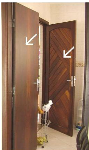
Figura 44 - Problemas na configuração de portas em espaços reduzidos: entre a sala e a cozinha e entre a cozinha e a lavanderia
