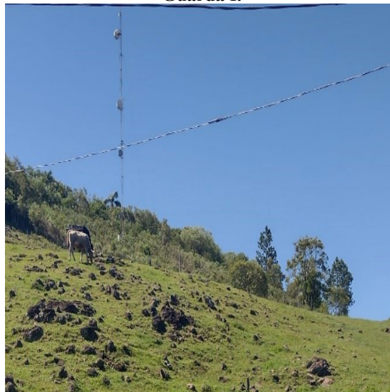
Figura 16 – Torre com a principal antena de conexão via rádio instalada no assentamento Anjo da Guarda I.
