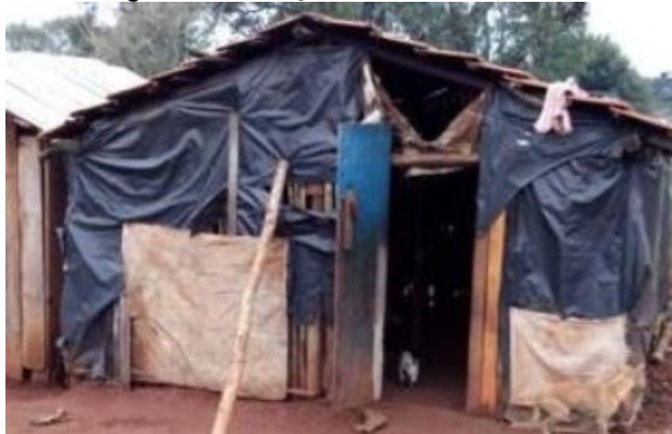
Figura 8 - Habitação em estado inabitável
