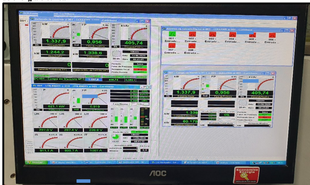
Figura 29 – Acompanhamento das Subestações da Fábrica através do sistema de gerenciamento de energia elétrica
