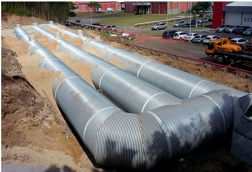
Figura 14 - Reservatório de detenção subterrâneo
