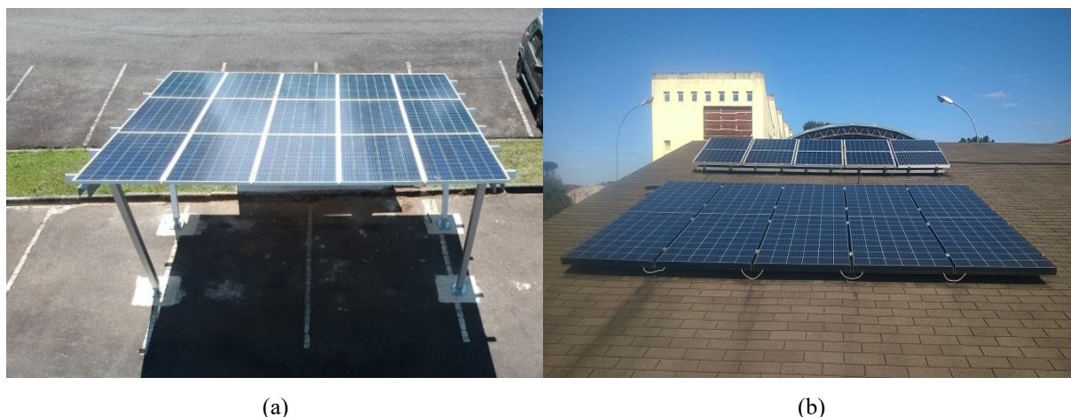
Figura 34 – Sistemas fotovoltaicos de baixa potência. (a) Garagem solar e (b) residência.
