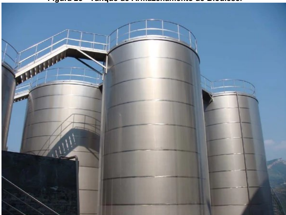
Figura 25 - Tanque de Armazenamento de Biodiesel
