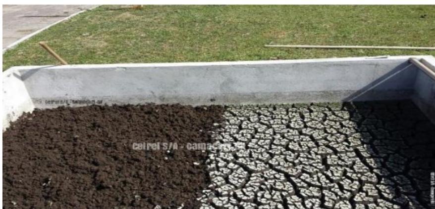
Figura 78 - Leito de secagem com piso de blocos drenantes utilizado no tratamento de resíduos sólidos da Mangut .
