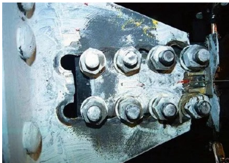
Figura 4.18 – Ruptura da chapa por cisalhamento de bloco.
