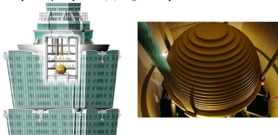
Figura 7: a) Amortecedor de Massa Sintonizado tipo pêndulo instalado no Edifício Taipei – representação esquemática; b) Imagem do dispositivo AMSP instalado.
