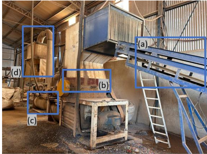
Figura 7 - Moinho de facas composto por (a) esteira de alimentação; (b) conjunto de facas; (c) secadora e; (d) silo.
