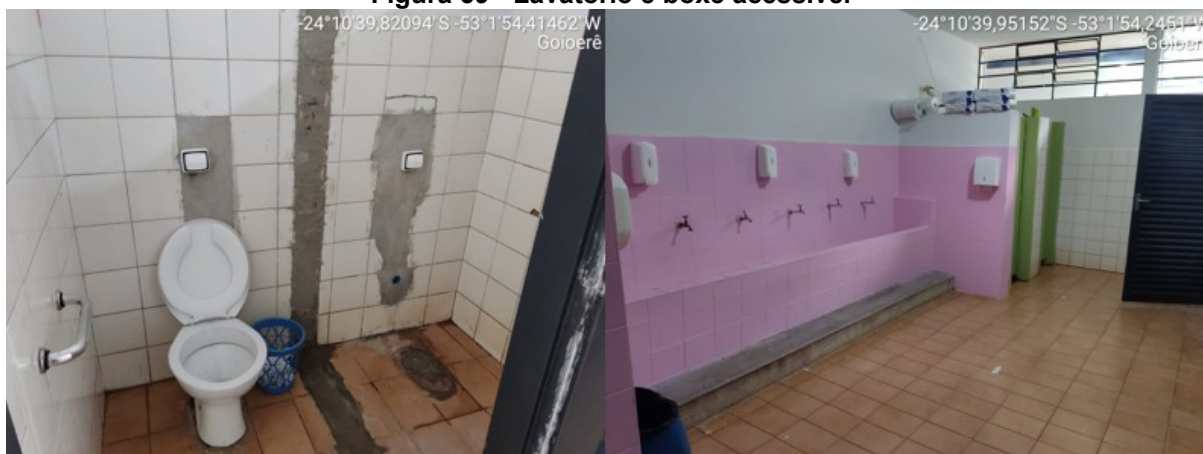
Figura 59 - Lavatório e boxe acessível
