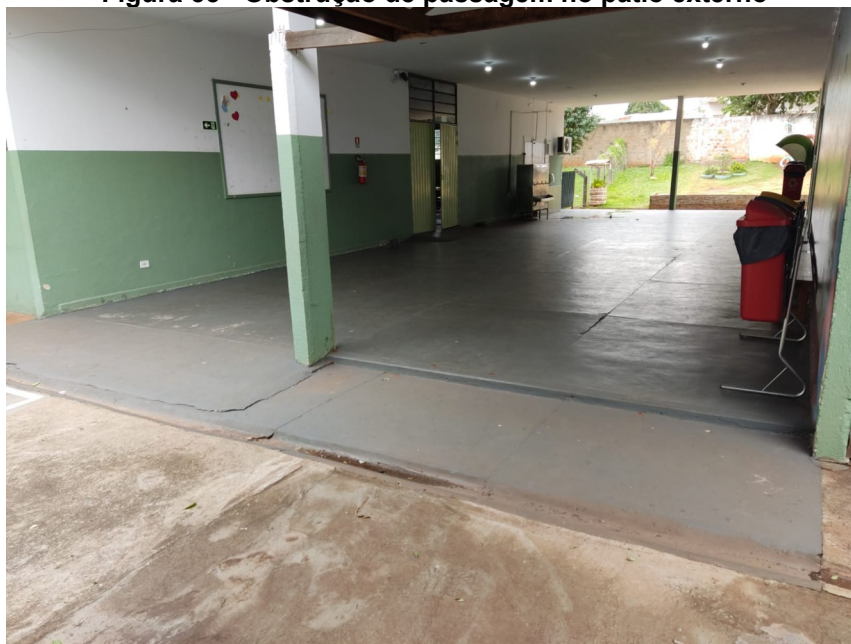
Figura 55 - Obstrução de passagem no pátio externo
