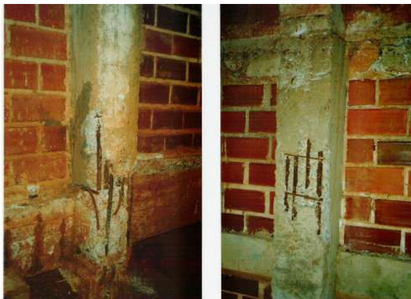
Figura 4 - Corrosão da armadura de concreto de um elemento estrutural (pilar).
