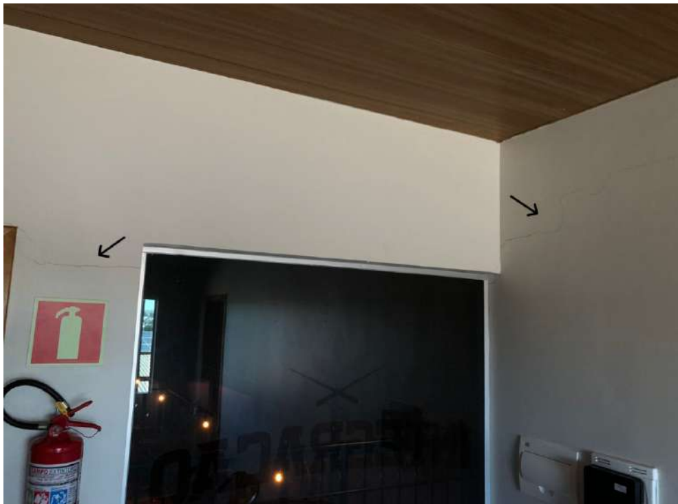
Figura 23 - Parede do quarto 1 do primeiro andar com a ocorrência de fissuras.
