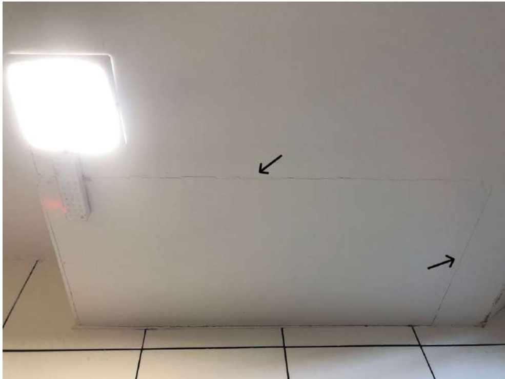
Figura 31 - Teto da cozinha localizada no térreo com a ocorrência de fissuras.
