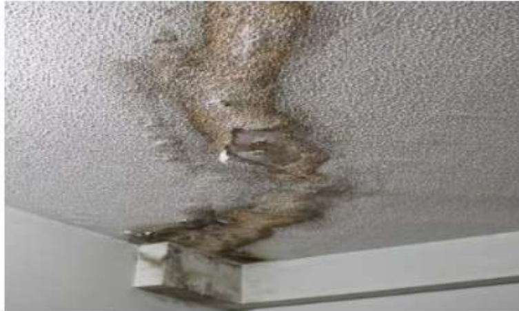
Figura 1 - Manchas no teto ocasionadas por goteira.
