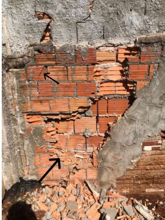
Figura 30 - Outro lado do muro de divisa localizado nos fundos com a ocorrência de fissuras, descolamento do acabamento e quebra da alvenaria.
