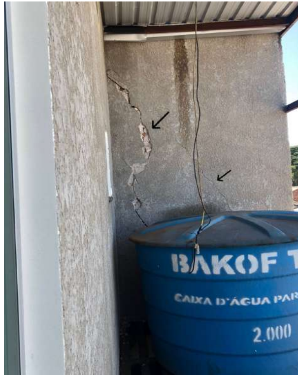
Figura 28 - Parte dos fundos do muro de divisa com a ocorrência de fissuras.
