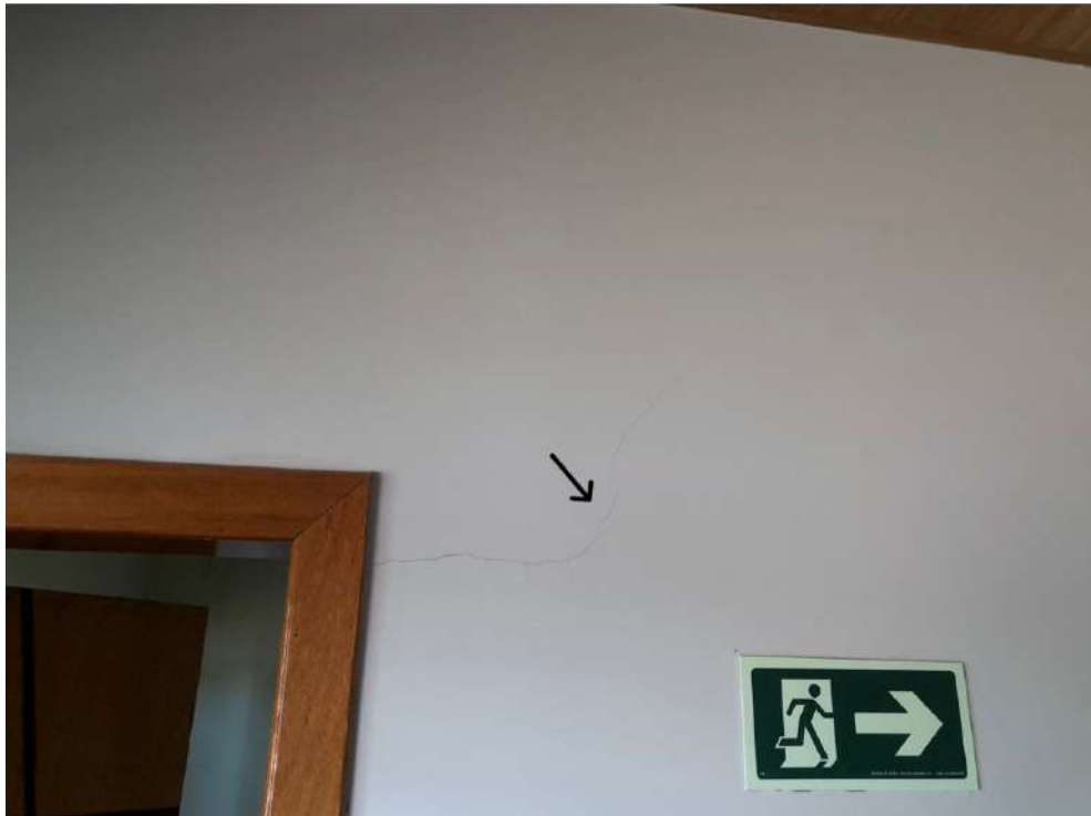
Figura 25 - Parede do quarto 2 do primeiro andar com a ocorrência de fissuras.
