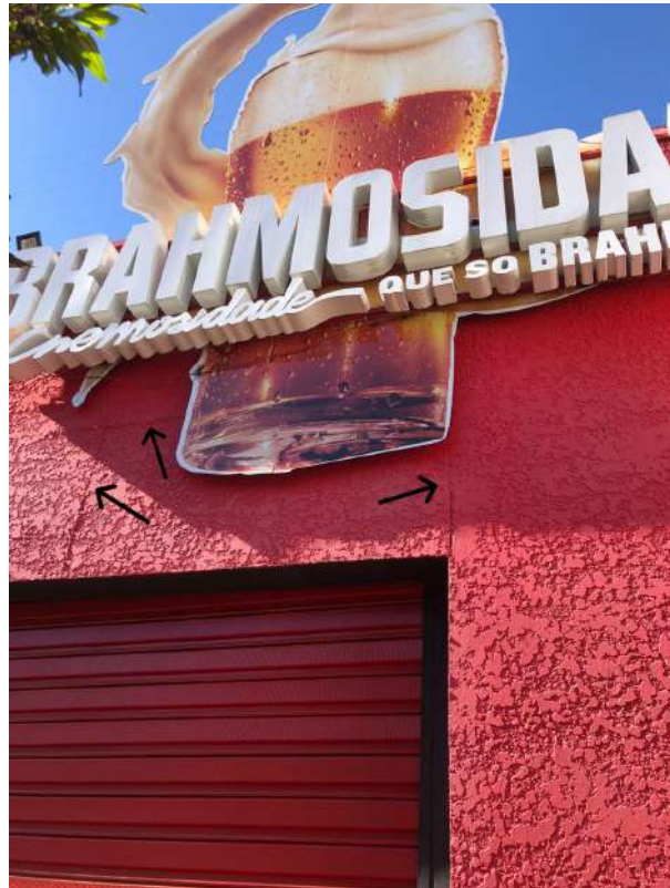
Figura 16 - Fachada do imóvel com a ocorrência de fissuras.
