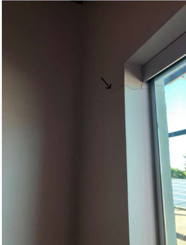
Figura 24 - Parede do quarto 1 do primeiro andar com a ocorrência de fissuras.
