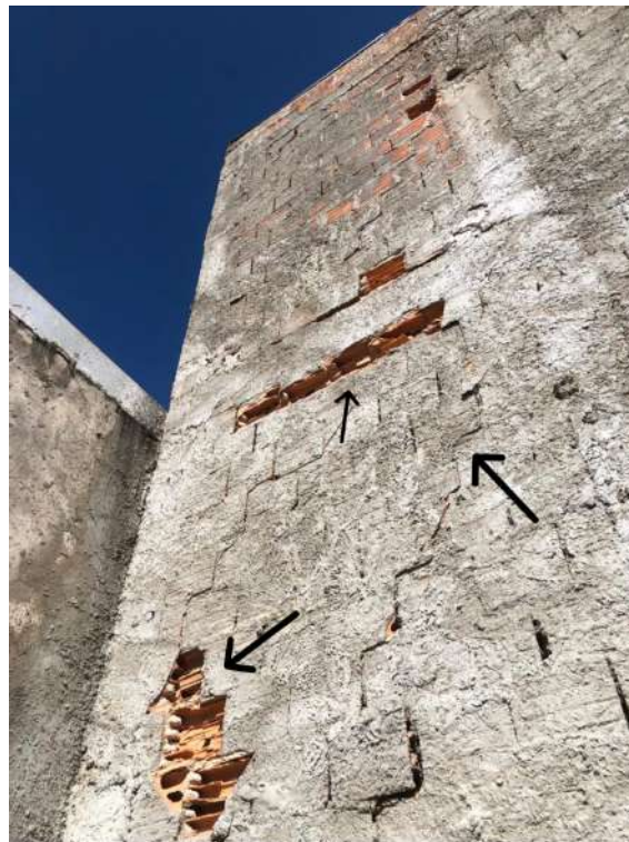
Figura 29 - Outro lado do muro de divisa localizado nos fundos com a ocorrência de fissuras, descolamento do acabamento e quebra da alvenaria.
