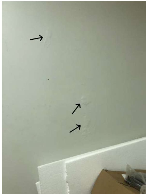
Figura 21 - Parede do quarto 1 do primeiro andar com a ocorrência de bolhas devido a umidade.
