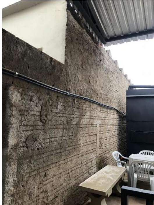
Figura 13 - Vista do muro de divisa do imóvel 2 com a parte dos fundos da obra.
