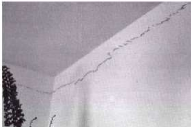
Figura 2 - Fissura horizontal com componentes inclinados (escamas) por movimentação da laje de cobertura.
