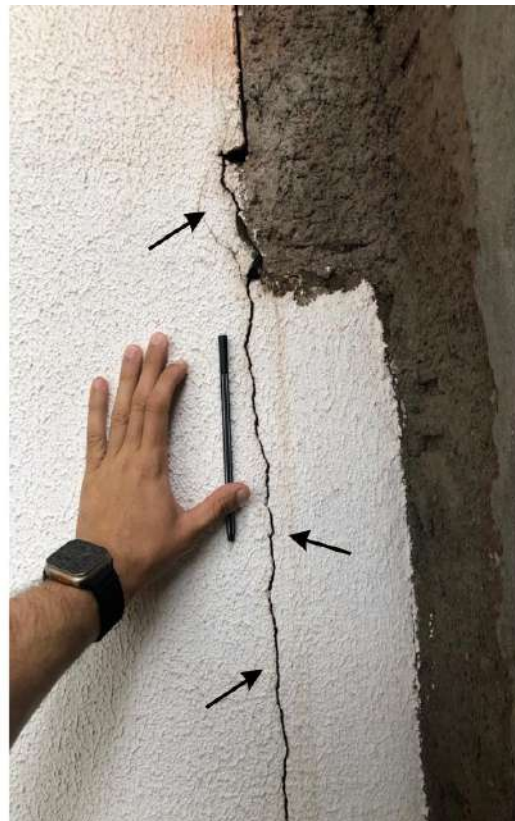
Figura 12 - Vista do muro de divisa do imóvel 2 com a parte dos fundos da obra com presença de trincas.
