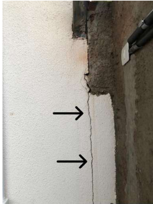
Figura 11 - Vista do muro de divisa do imóvel 2 com a parte dos fundos da obra com presença de trincas.
