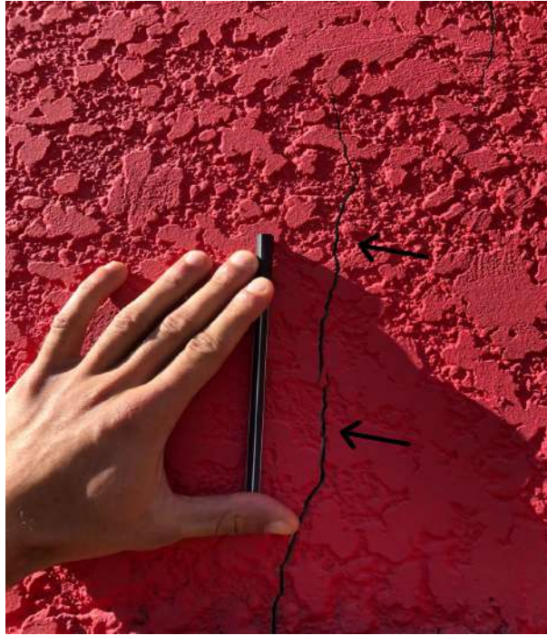
Figura 18 - Fachada do imóvel com a ocorrência de fissuras.
