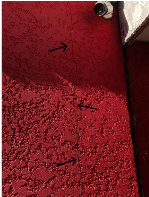
Figura 17 - Fachada do imóvel com a ocorrência de fissuras.
