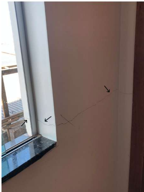
Figura 27 - Parede do quarto 2 do primeiro andar com a ocorrência de fissuras.
