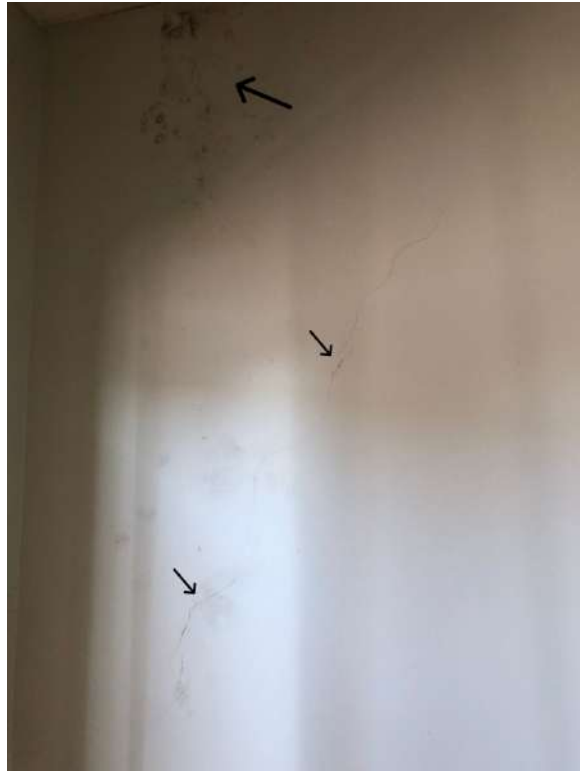
Figura 26 - Parede do quarto 2 do primeiro andar com a ocorrência de fissuras e manchas devido a umidade.
