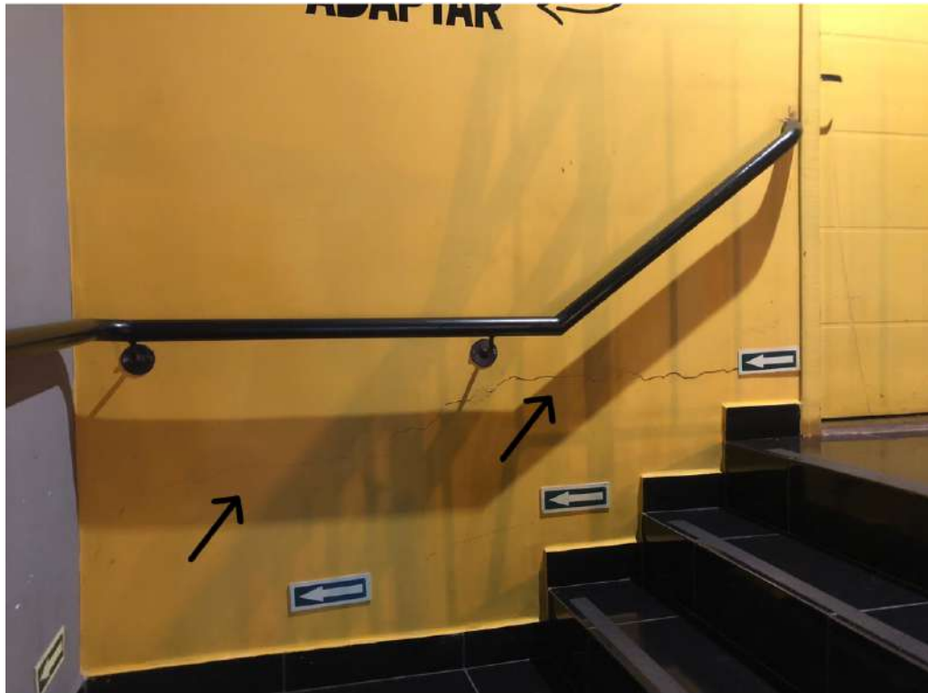
Figura 19 - Parede da escada para o primeiro andar com a ocorrência de fissuras.
