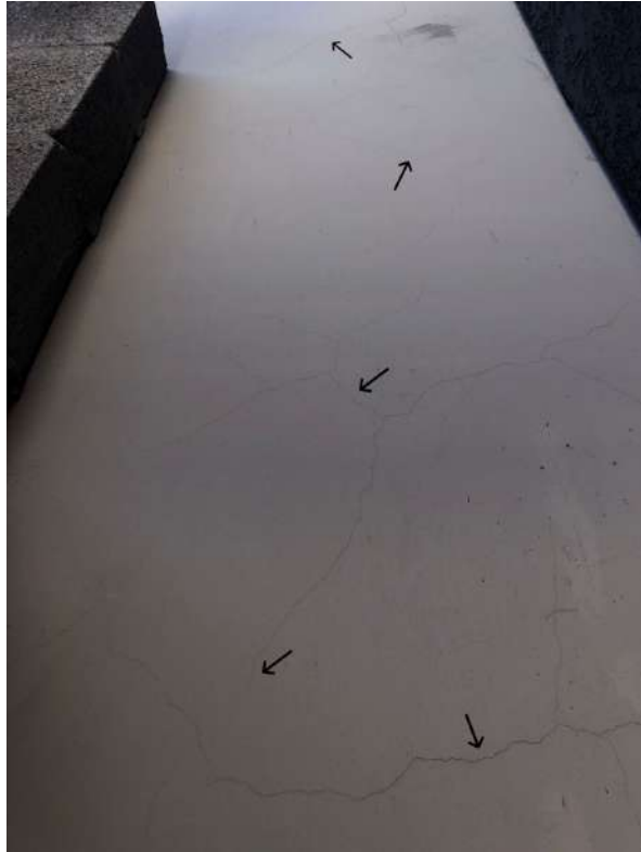
Figura 32 - Parede da área coberta do térreo com a ocorrência de fissuras.
