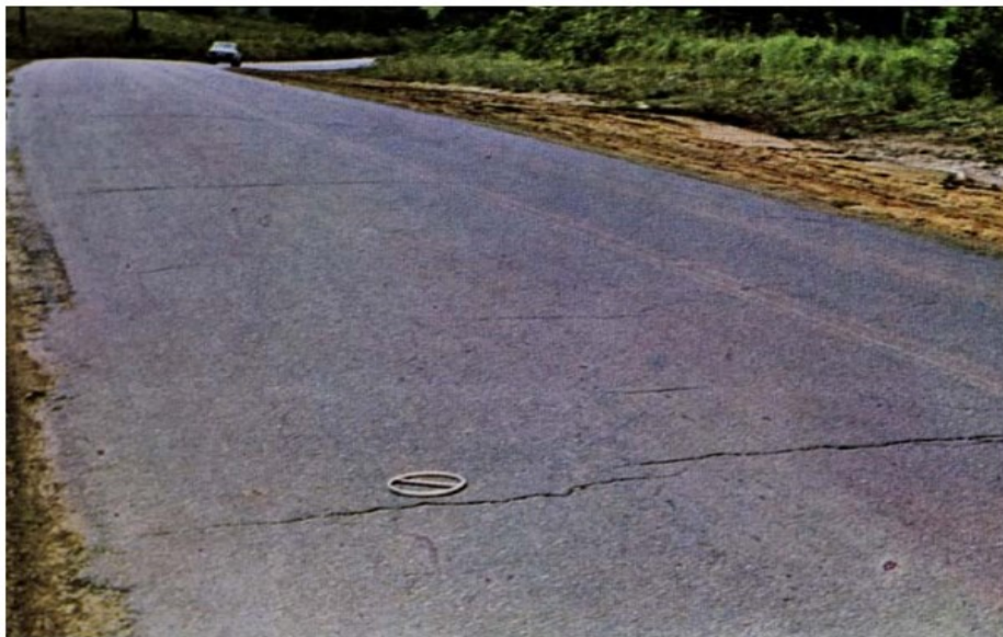
Figura 1 – Trinca isolada - Transversal
