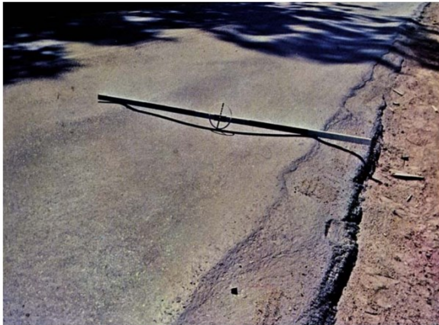
Figura 5 – Afundamento da trilha de roda
