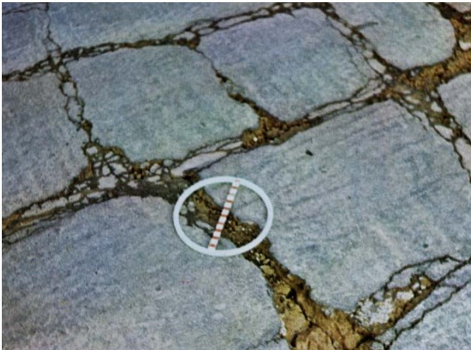
Figura 4 – Trinca interliga – tipo bloco
