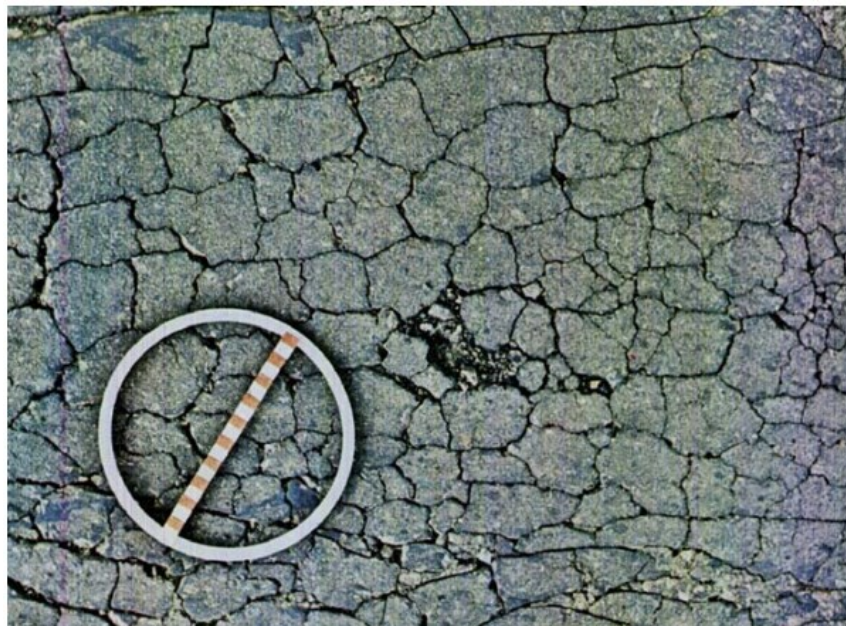
Figura 3 – Trinca interligado – tipo jacaré
