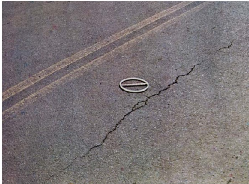
Figura 2 – Trinca isolada – Longitudinal
