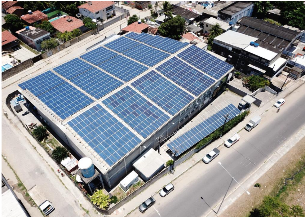
Figura 12 – Painéis solares sobre cobertura de edificação e estacionamento
