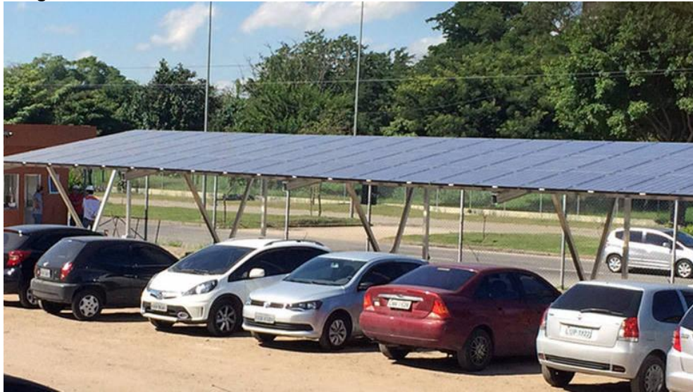
Figura 13 – Painéis solares sobre a cobertura do estacionamento da UFRJ
