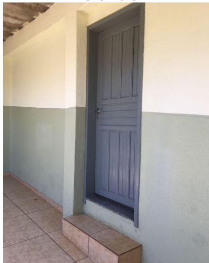
Fotografia 10 – Desnível da segunda entrada do auditório do Colégio Estadual 14 de Dezembro.
