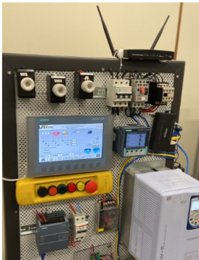
Figura 38 – Modem roteador instalado na parte superior da bancada
