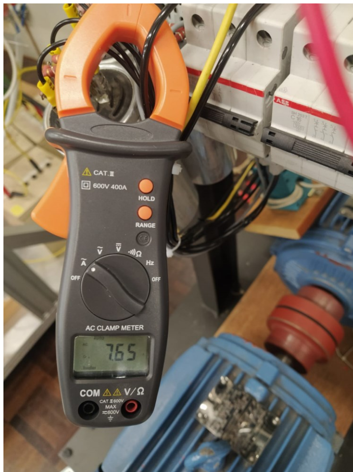
Figura 54 – Medida da corrente elétrica em uma das fases no teste de confiabilidade
