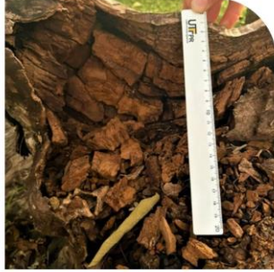
Figura 48: Madeira colapsada por podridão parda
