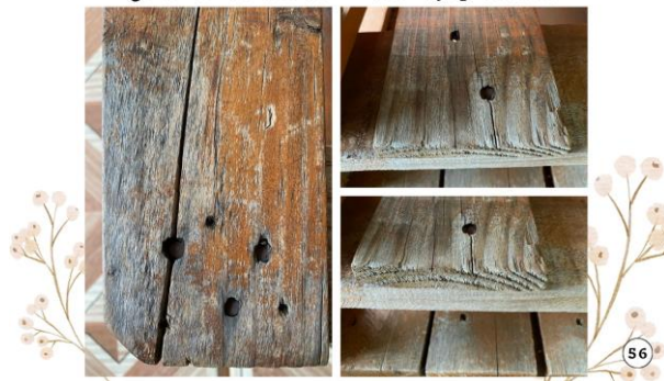
Figura 46: Rachadura em madeira já processada
