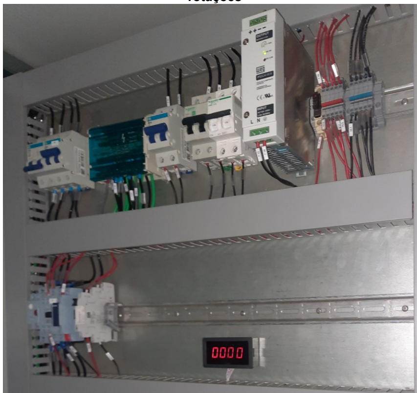
Fotografia 12 - Disjuntores, disjuntor motor, contactores, string box , fonte 12V e indicador de rotações
