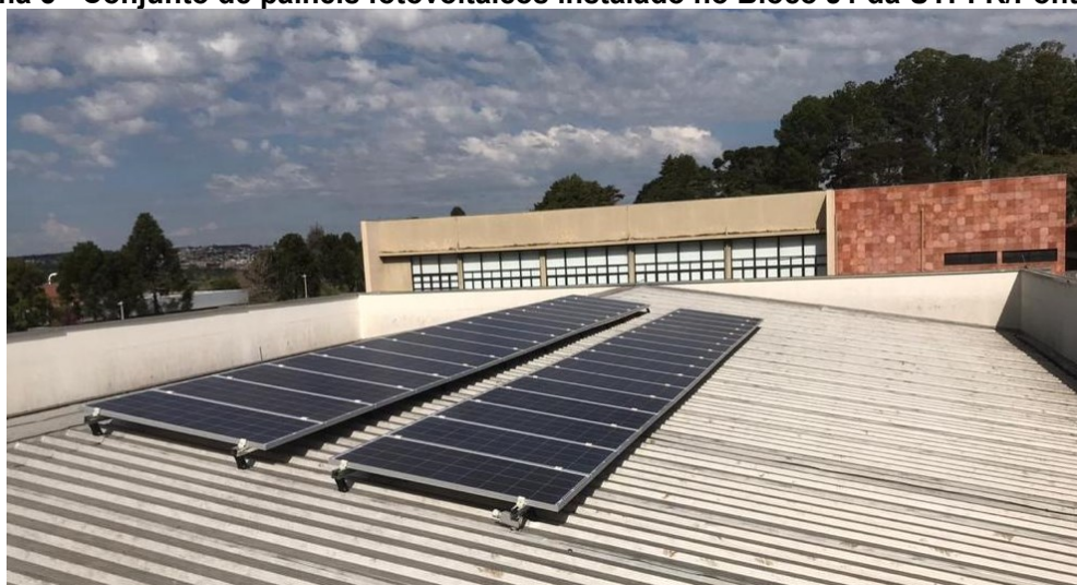
Fotografia 5 - Conjunto de painéis fotovoltaicos instalado no Bloco J1 da UTPFR/Ponta Grossa
