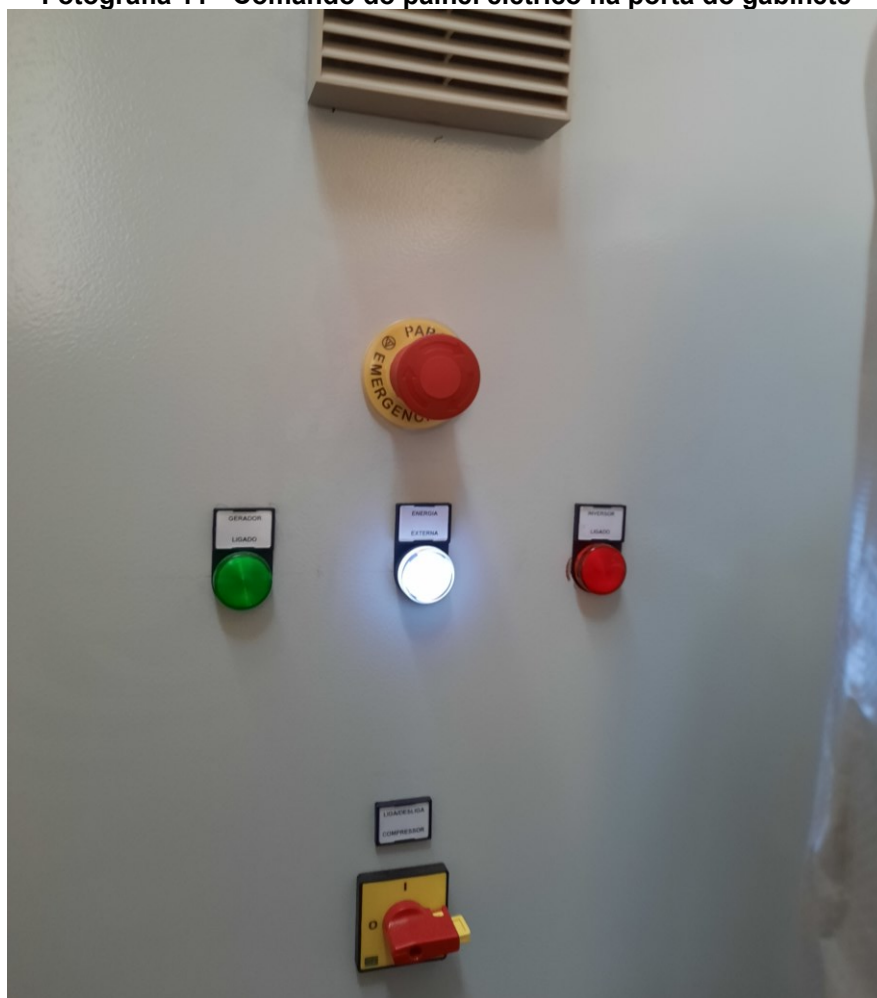
Fotografia 11 - Comando do painel elétrico na porta do gabinete
