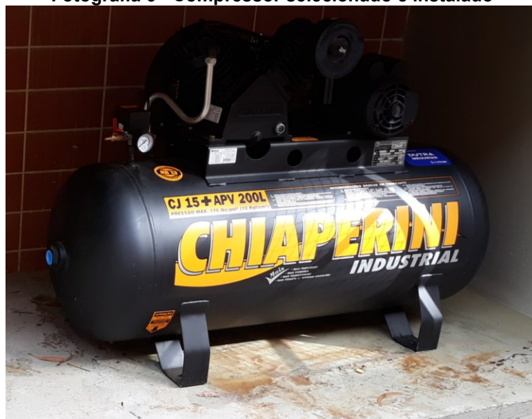
Fotografia 6 - Compressor selecionado e instalado
