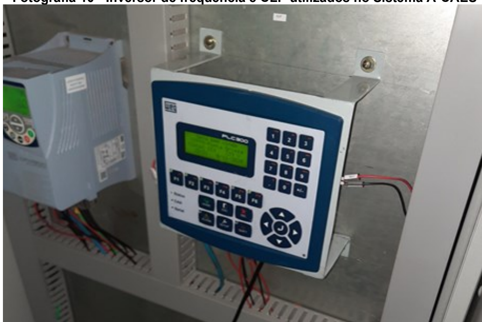
Fotografia 10 - Inversor de frequência e CLP utilizados no Sistema A-CAES
