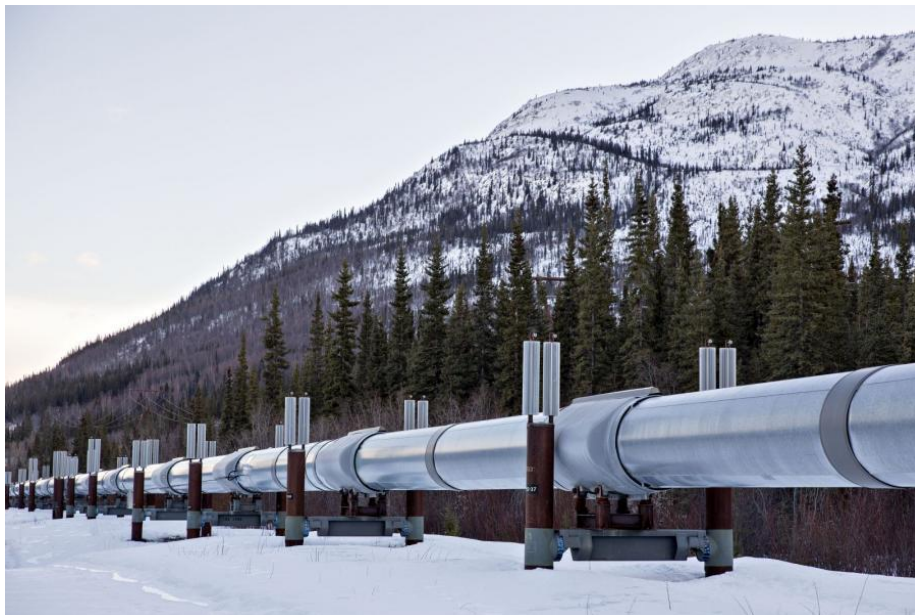
Fotografia 3 - Aplicação de termossifão na Alaska Pipeline Transportation .
