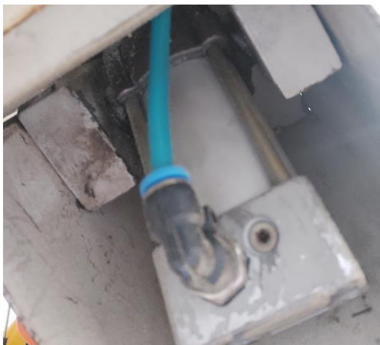
Figura 14 – Atuador Pneumático do Descarregador
