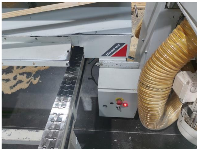
Figura 10 – Painel Elétrico e Esteira de Correntes Retas de Alimentação do Descarregador.
