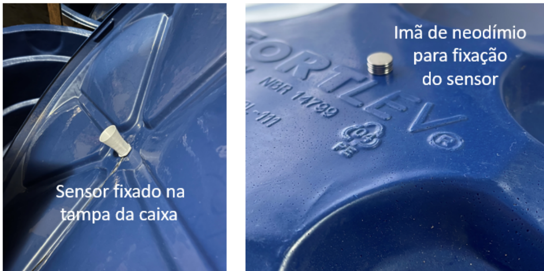
Figura 62 – Fixação do sensor na caixa d'água
