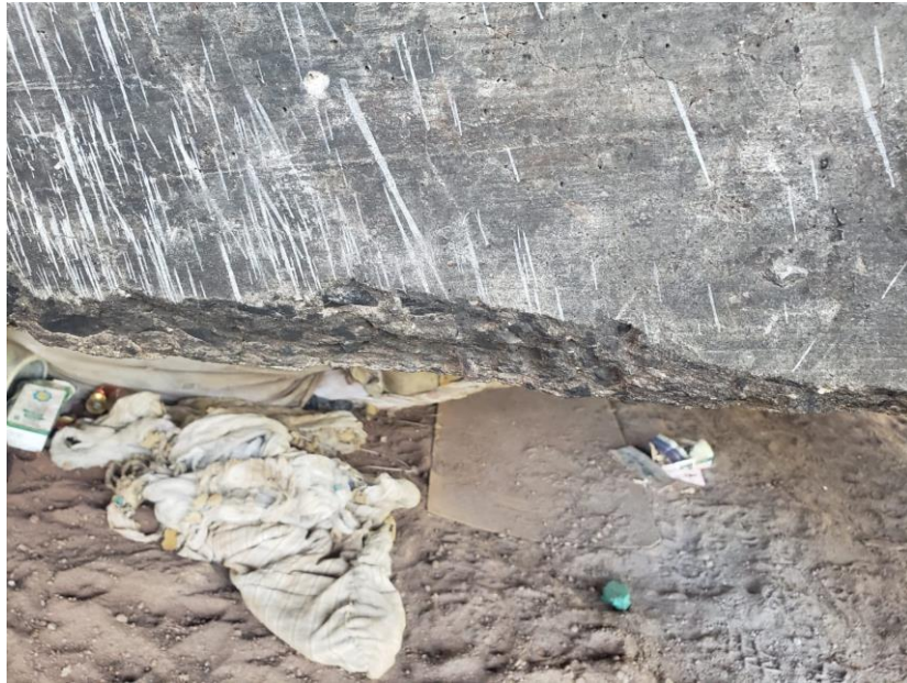
Figura 26 – Foto aproximada da exposição das armaduras na viga longarina 1.
