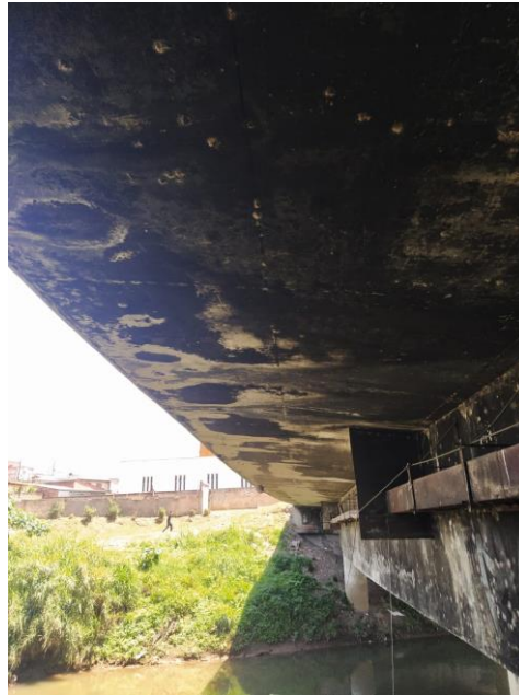
Figura 31 – Manchas de eflorescência na laje próximo a viga longitudinal 2.
