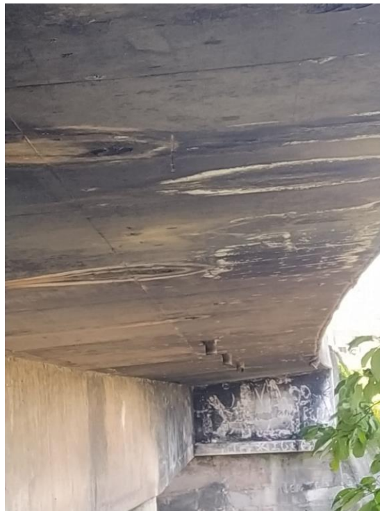
Figura 29 – Eflorescência na laje.
