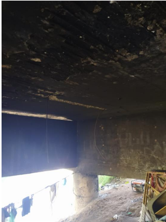
Figura 22 – Armaduras expostas da laje.
