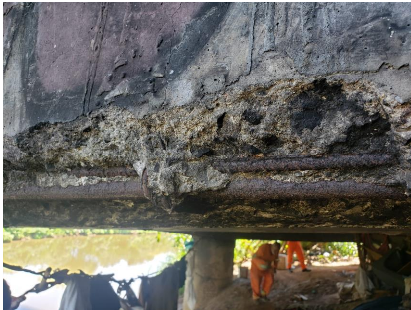
Figura 27 – Exposição das armaduras na viga longarina 2 (VL2).
