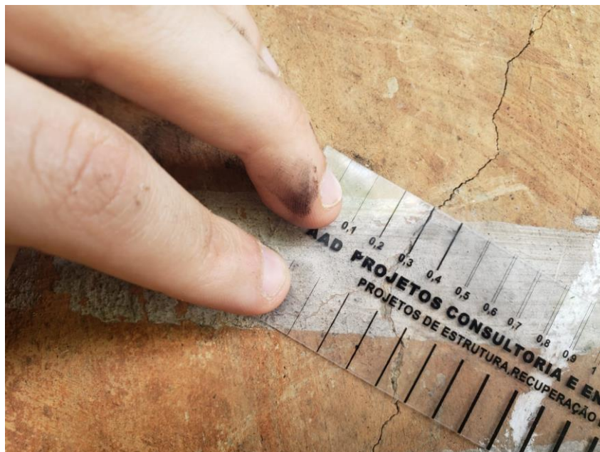
Figura 34 – Fissuras de 0,3 mm na viga longarina 1.
