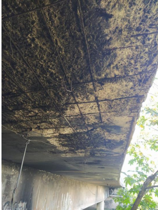
Figura 30 – Armaduras expostas abaixo do acostamento.
