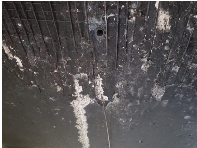
Figura 23 – Vista inferior das armaduras expostas da laje.
