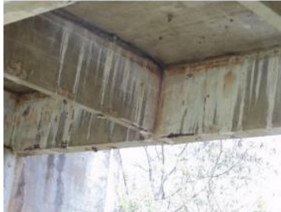
Figura 8 – Eflorescência sobre pontes de concreto armado.
