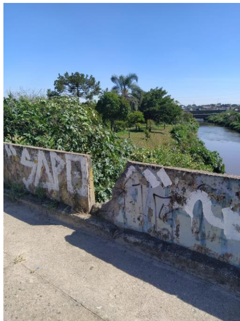
Figura 36 – Parte danificada da OAE.
