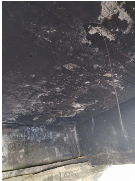
Figura 21 – Extremidade da laje exposta ao fogo.
