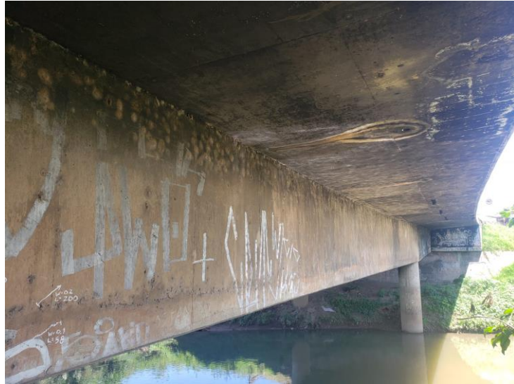
Figura 28 – Manchas de eflorescência próximos aos tubos de drenagem.
