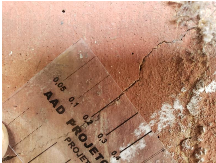
Figura 33 – Fissura de 0,2 mm na viga longarina 2.
